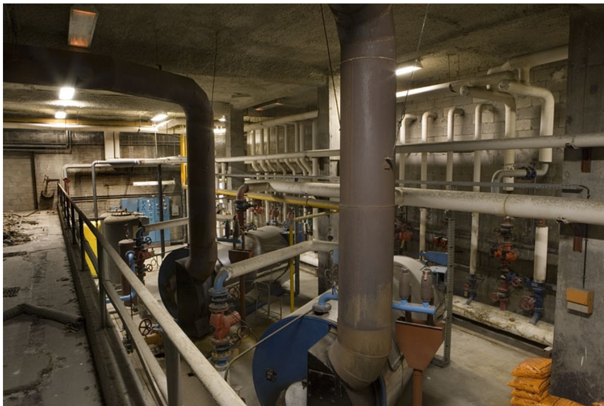
Bâtiment D. Sous-sol. Vue de la chaufferie. 25, Montbéliard, 1 B rue Pierre Donzelot
