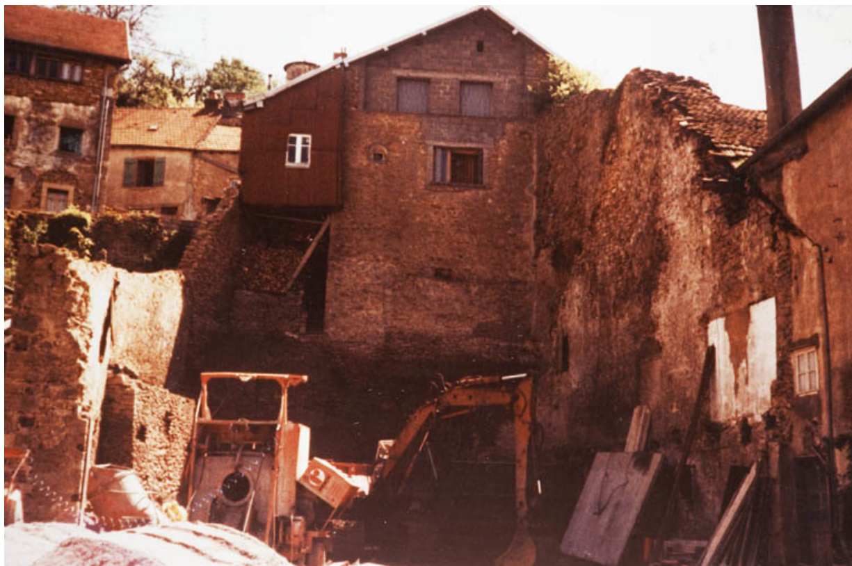
Une partie du mur d'enceinte en cours de destruction vers 1983-1984, 29 Grande Rue. 25, Rougemont
