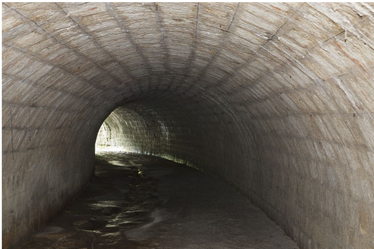
Intérieur du pont, aqueduc du Vaubillon (n°6) en direction de La Ferrière. 25, Jougne
