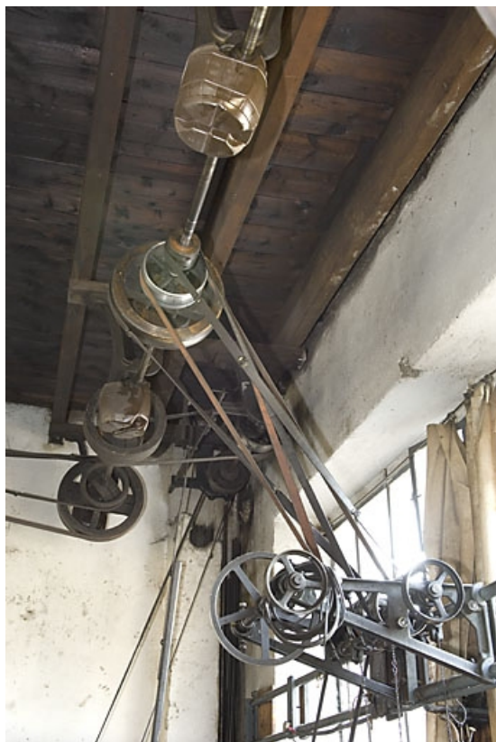
Arbre et console de transmission du tour horizontal (C). 25, Besançon, 11 rue Larmet
