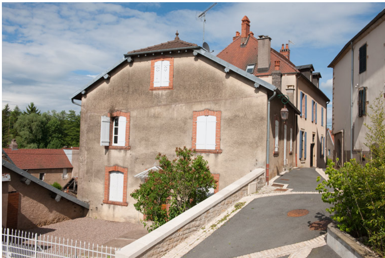
Vue rapprochée depuis la rue de la Traverse. 25, Rougemont, 14 rue du Vieux Moulin
