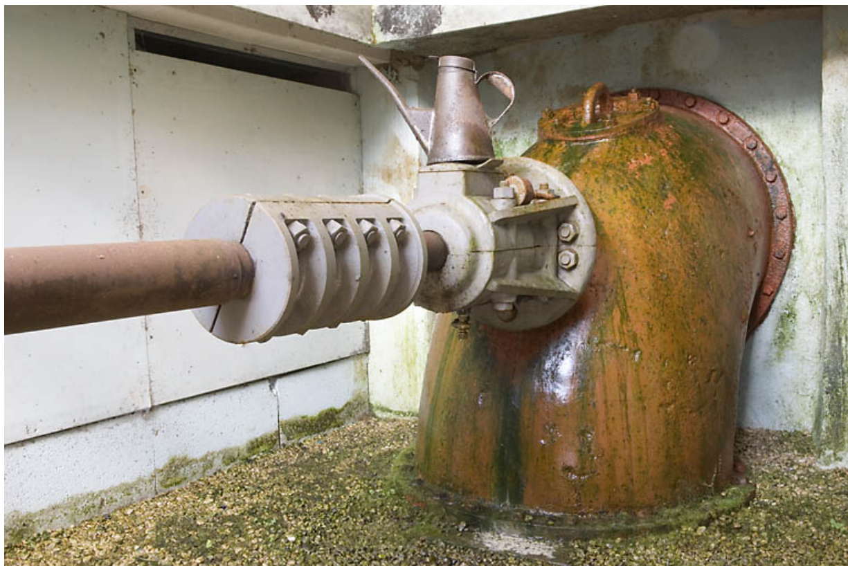
Usine : axe de transmission, sortant d'une conduite forcée.
