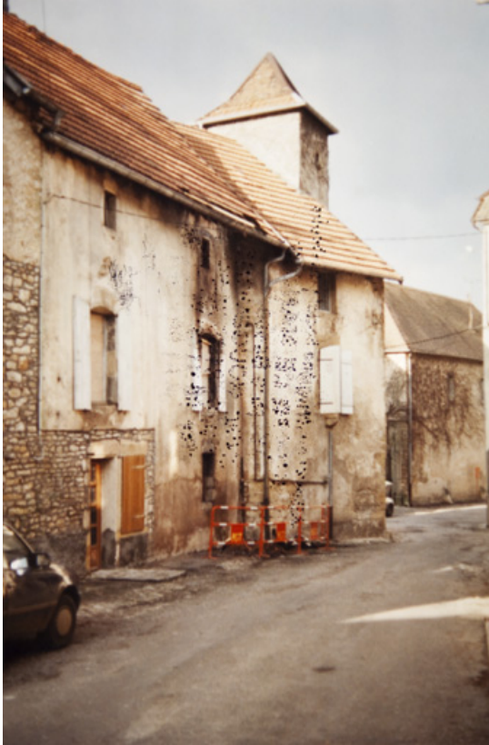
Bâtiment : vue générale depuis la rue Basse, après l'incendie (vers 2000). 25, Rougemont, 6, 8 rue Basse
