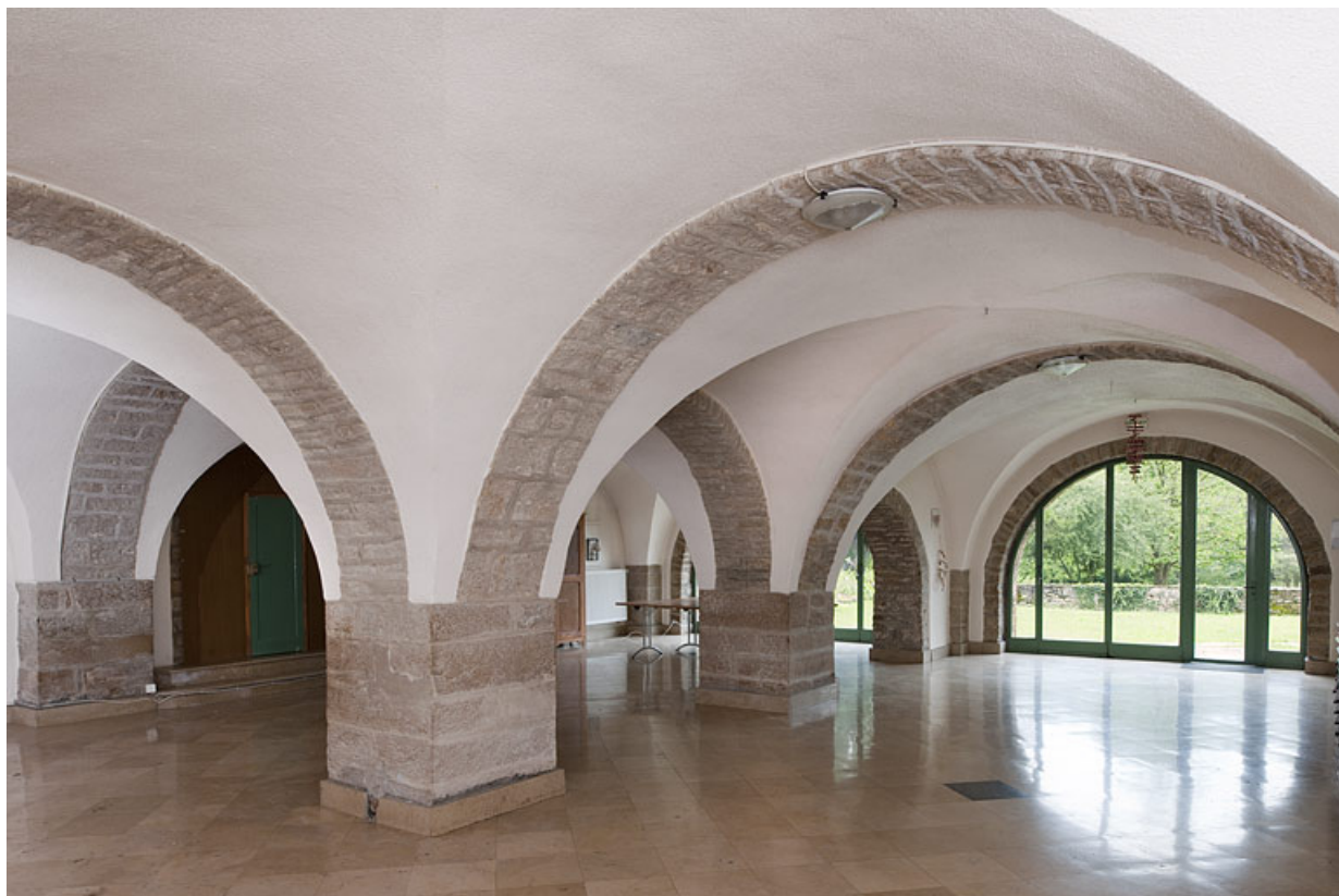
Vue générale des caves voûtées d'arêtes, en direction de la rue des Fossés. 25, Rougemont, 6, 8 rue Basse
