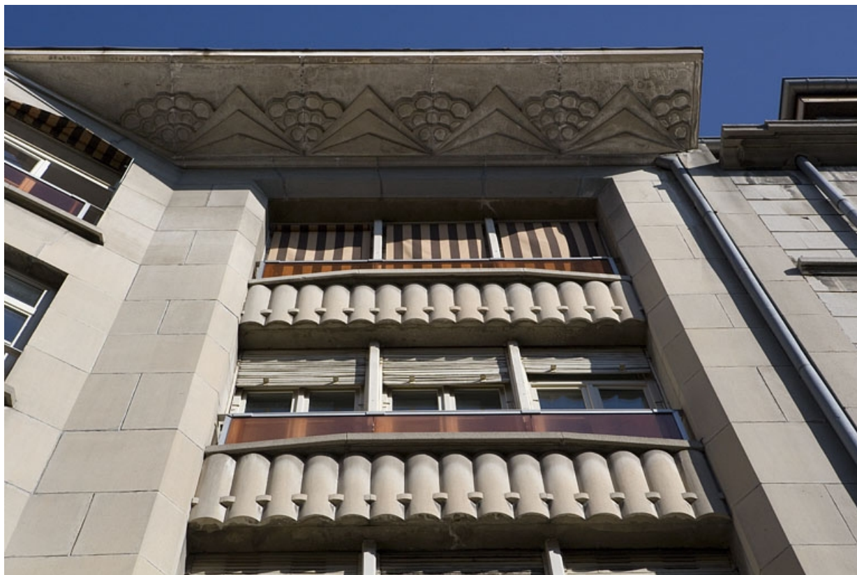
Partie gauche : détail du décor du dessous du balcon et des fenêtres.
