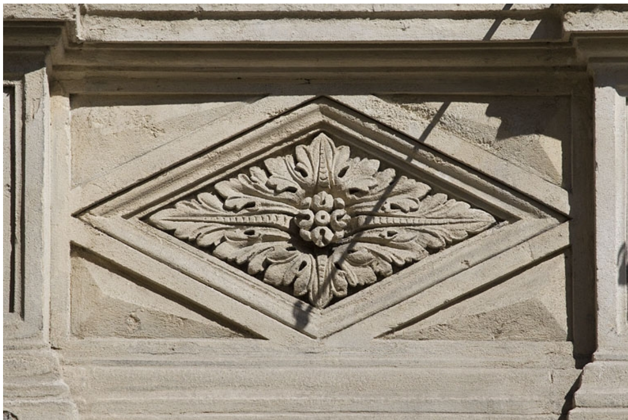
Façade antérieure, fenêtres du premier étage : détail d'un motif en losange sous une fenêtre.
