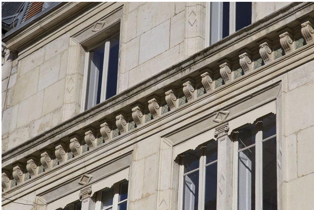
Façade antérieure : détail de la corniche entre les deuxième et troisième étages : de trois quarts droit. 25, Besançon, 14 rue Proudhon, lieudit : îlot Saint-Amour
