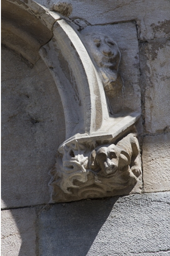
Façade antérieure, premier étage, baie centrale : détail de l'extrémité droite de l'archivolte. 25, Besançon, 19 rue Rivotte, lieudit : îlot Porte Rivotte
