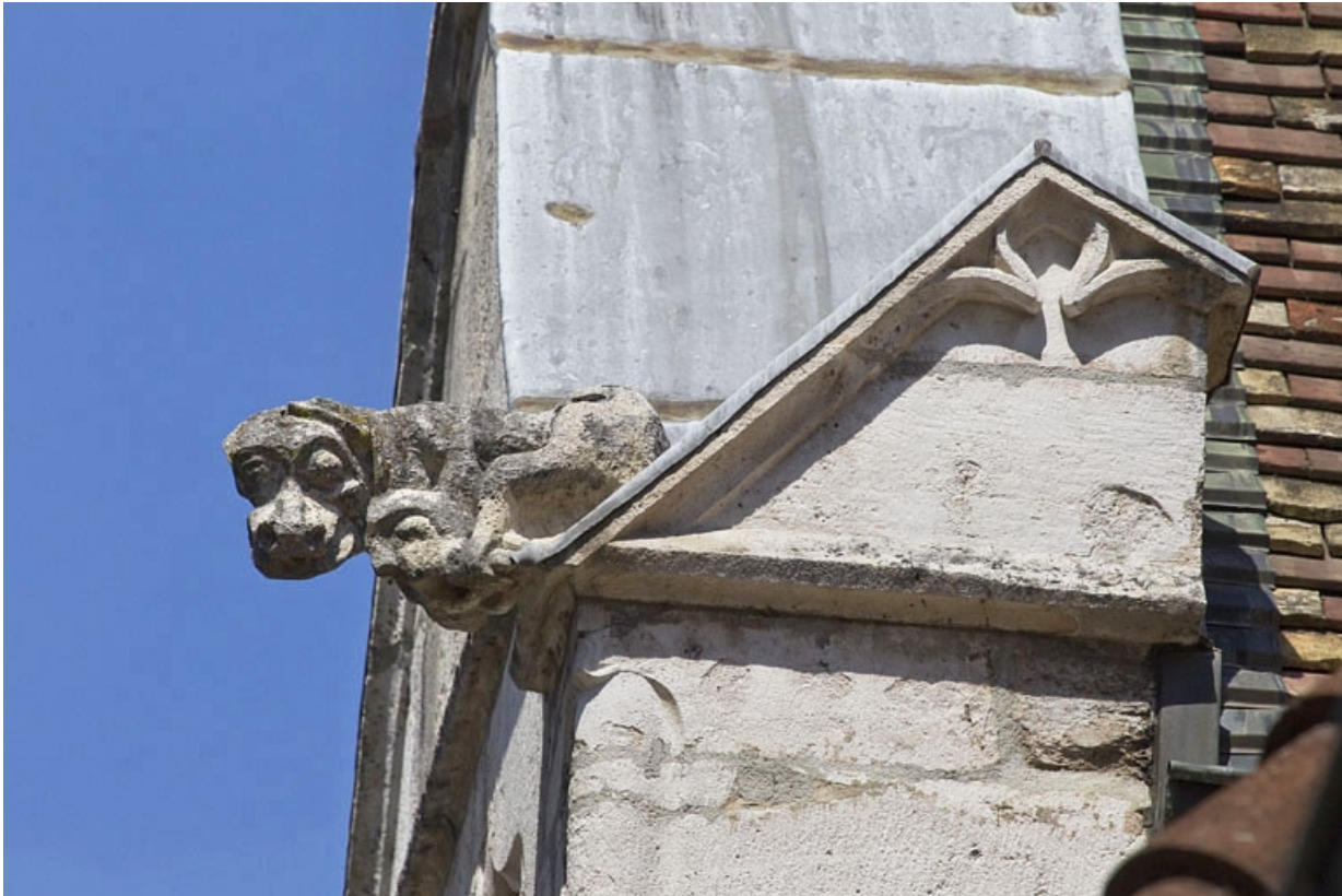
Façade antérieure, lucarne : détail d'une gargouille. 25, Besançon, 19 rue Rivotte, lieudit : îlot Porte Rivotte
