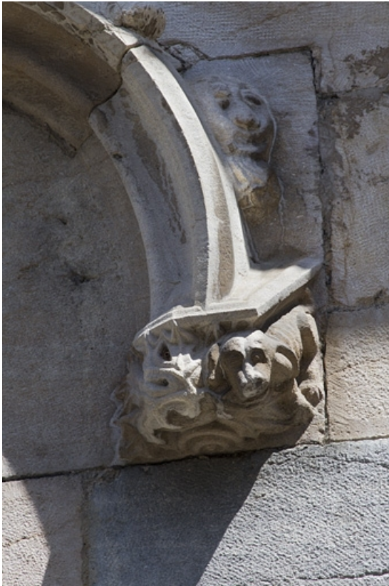
Façade antérieure, premier étage, baie centrale : détail de l'extrémité droite de l'archivolte. 25, Besançon, 19 rue Rivotte, lieudit : îlot Porte Rivotte
