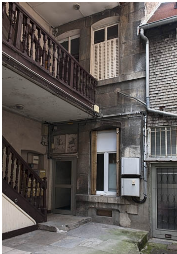
Façade sur cour du logis principal depuis la cour. 25, Besançon, 16 rue Courbet, lieu-dit : îlot Carmélites
