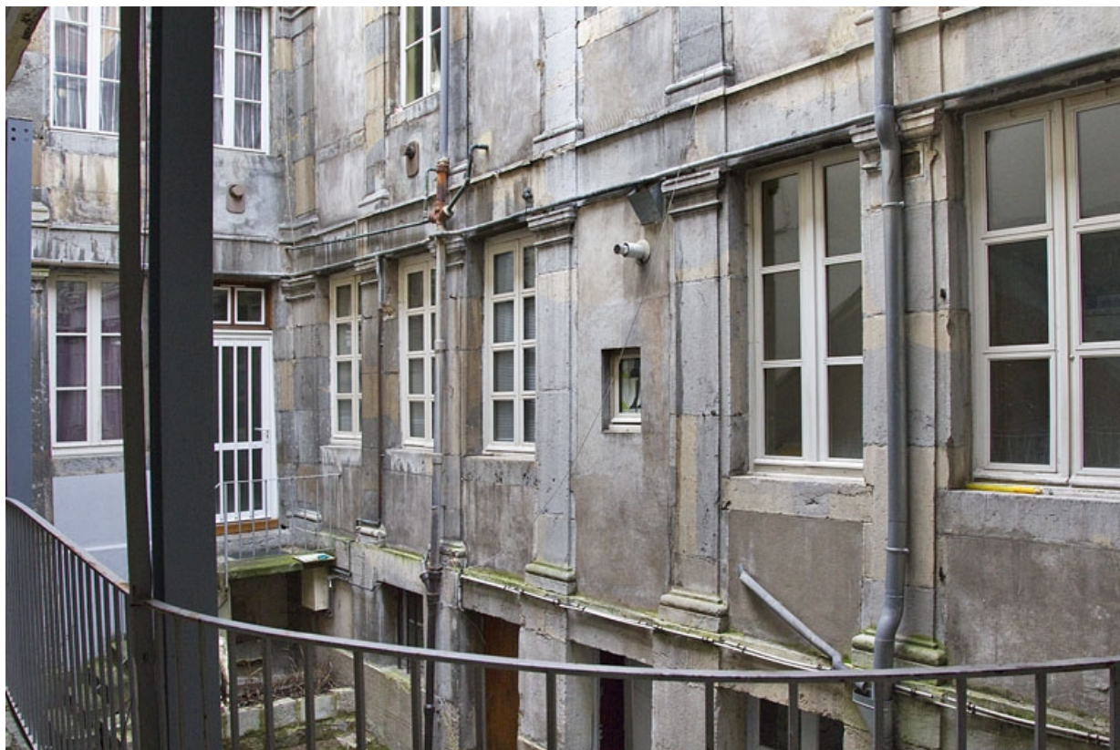
Logis secondaire, deuxième cour, vue d'ensemble de la partie basse des façades depuis l'escalier à cage ouverte : de trois quarts gauche.
