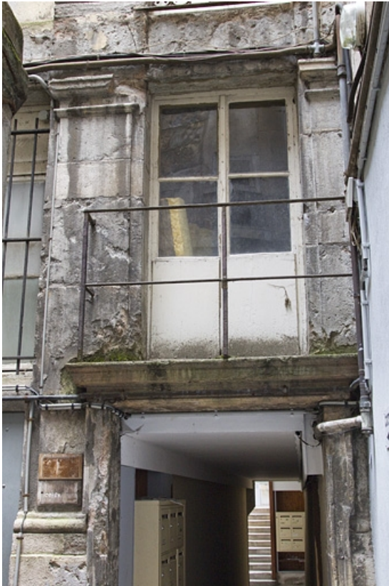
Logis secondaire : détail de la porte-fenêtre du premier étage au-dessus du couloir sur la première cour. 25, Besançon, 49 rue des Granges, lieudit : îlot Morand
