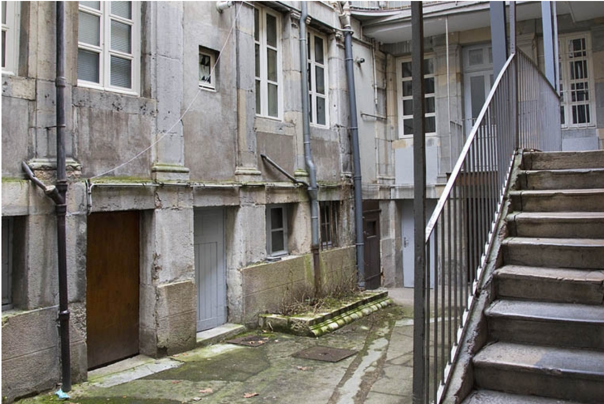
Logis secondaire, deuxième cour, façade en face de l'escalier à cage ouverte, partie droite : rez-de-chaussée et premier étage. 25, Besançon, 49 rue des Granges, lieudit : îlot Morand
