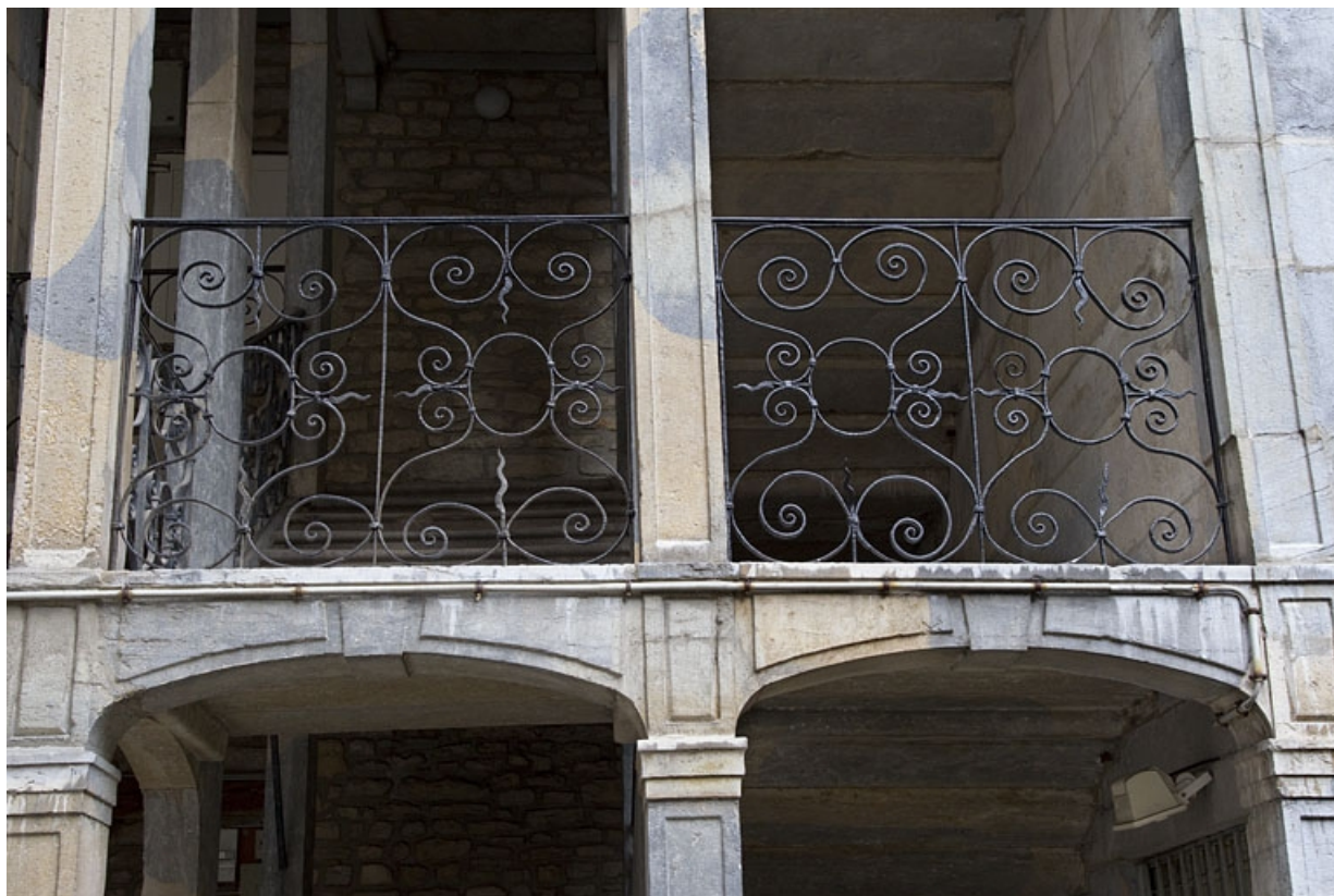
Logis principal : détail des garde-corps en ferronnerie de l'escalier à cage ouverte depuis l'extérieur.
