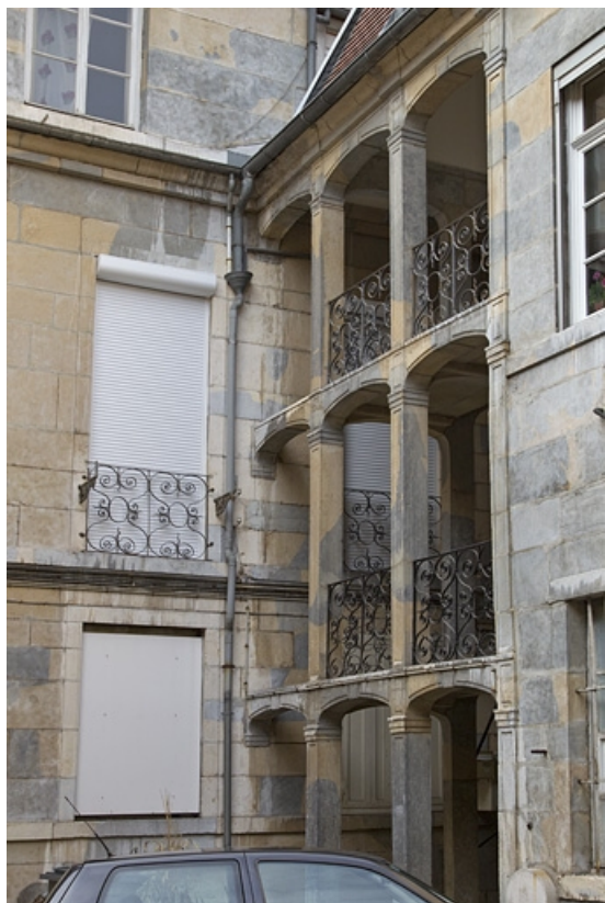
Logis principal : vue d'ensemble de l'escalier à cage ouverte, de trois quarts droit. 25, Besançon, 35 rue des Granges, lieudit : îlot Morand
