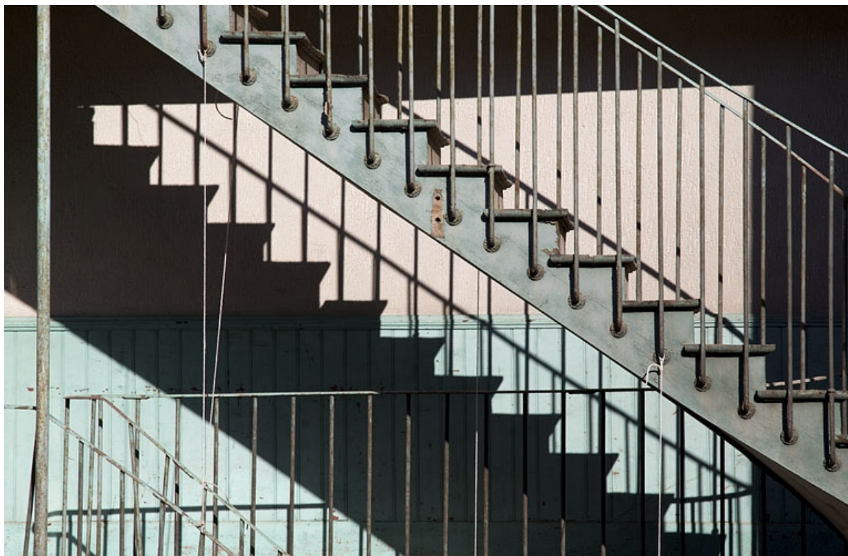
Détail de la rampe de l'escalier à cage ouverte depuis une maison voisine.
