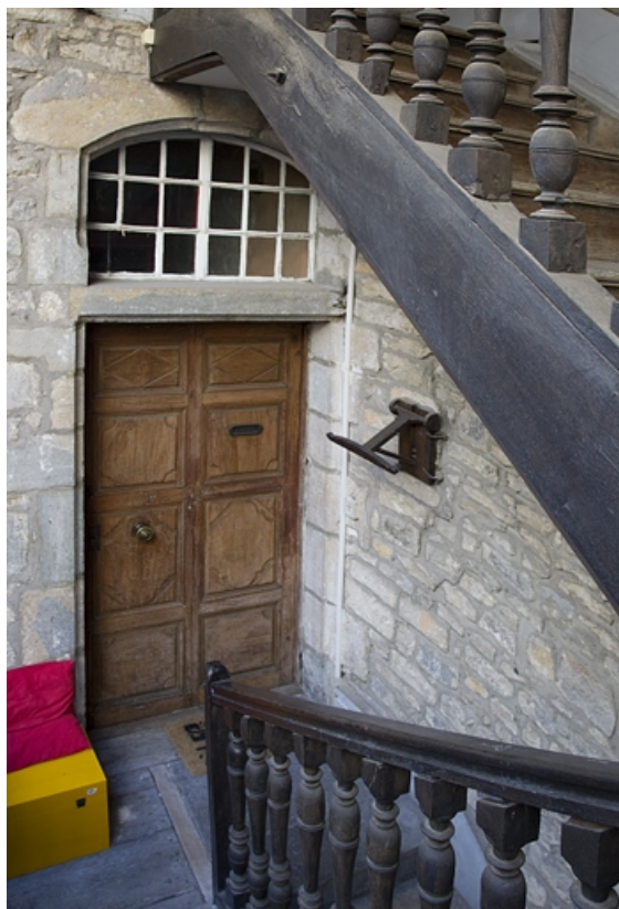
Logis principal, façade sur cour : détail de la porte d'entrée de l'appartement du premier étage. 25, Besançon, 3 rue Bersot, lieudit : îlot Proudhon
