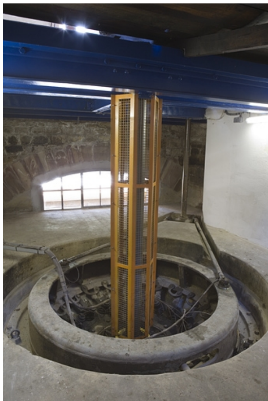
Bâtiment d'eau. Arbre de transmission vertical d'une turbine.
