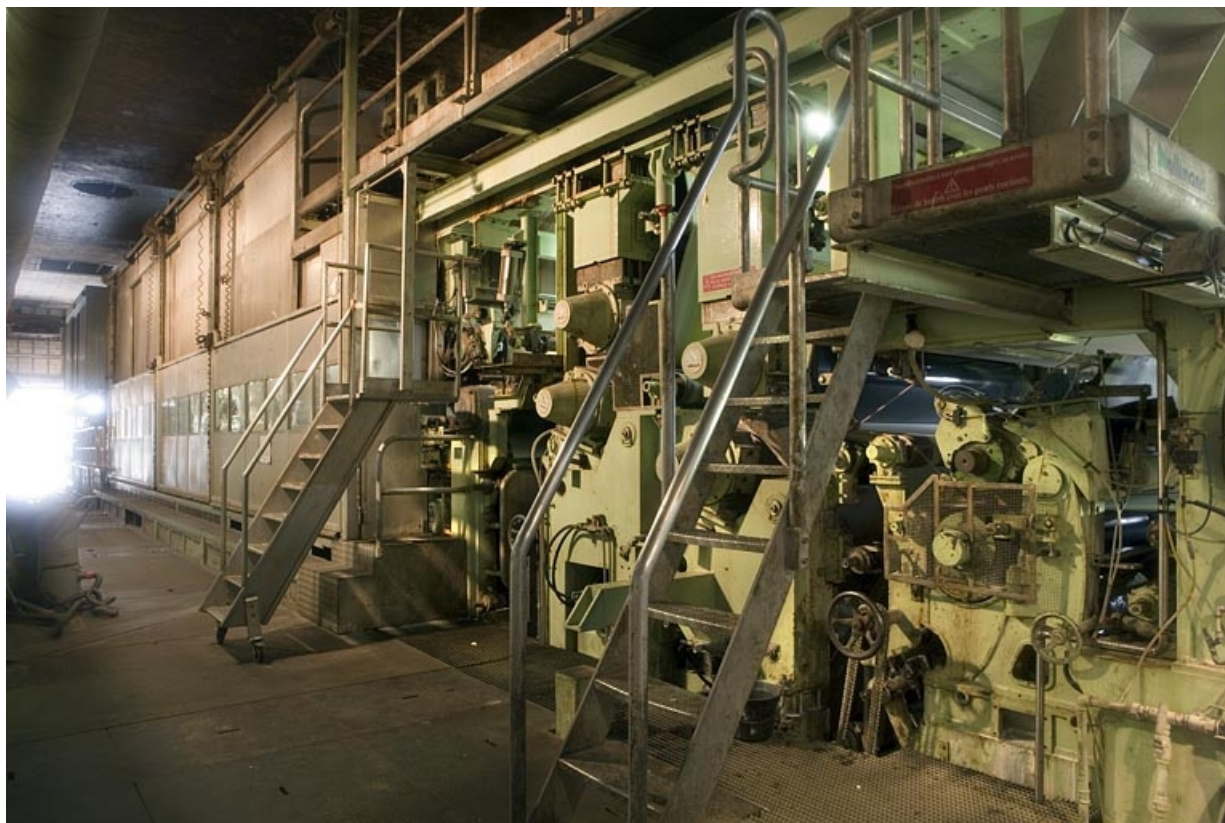
Atelier de la machine à papier. Le laminage. 25, Boussières rue Ernest Zuber
