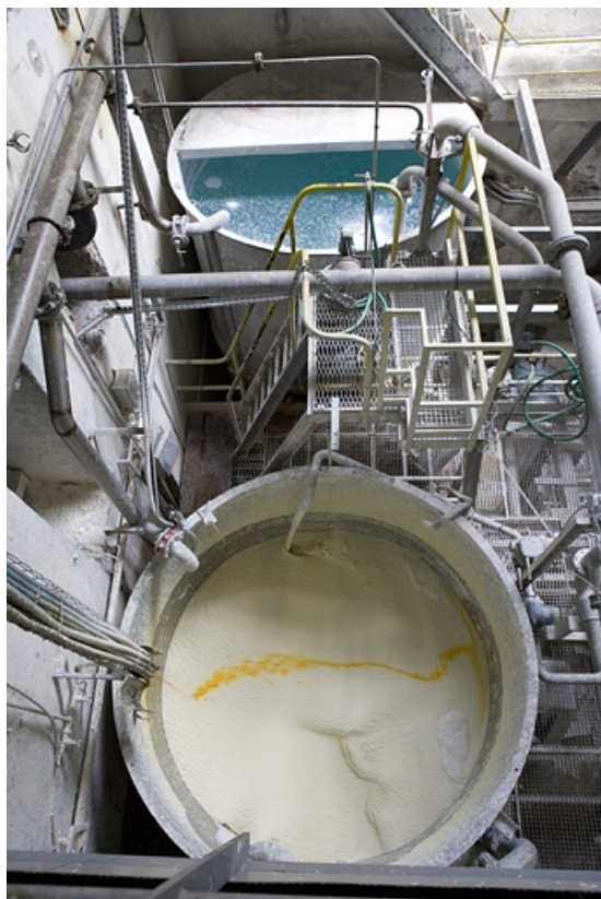
Atelier de fabrication (premier étage). Mélangeurs à colorants. 25, Boussières rue Ernest Zuber
