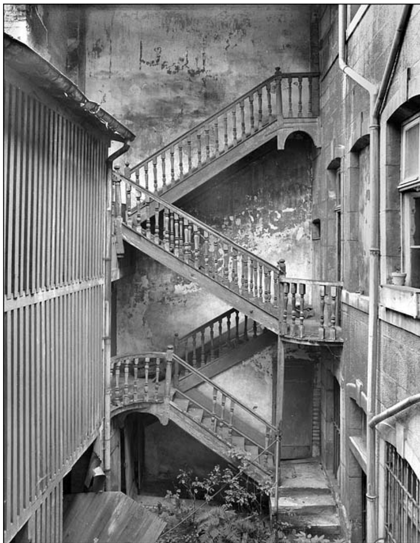
Vue rapprochée de l'escalier détruit situé dans la deuxième cour.
