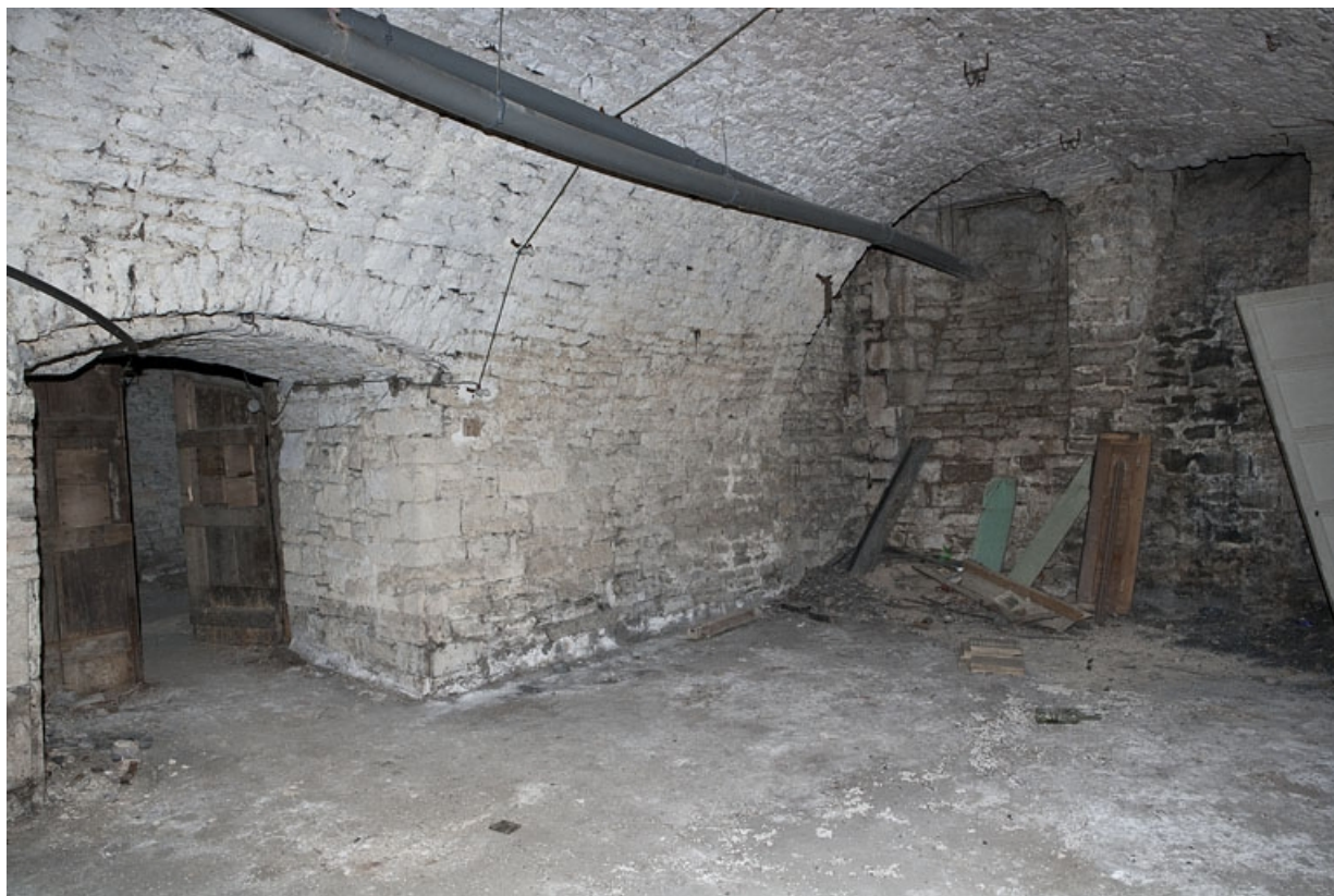
Logis principal, sous-sol : cave D, depuis le fond, de trois quart gauche.
