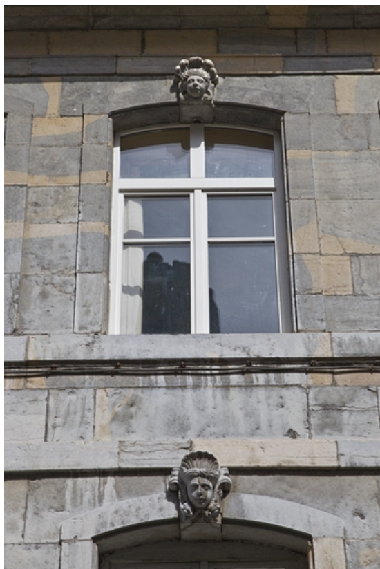
Logis principal, façade antérieure : détail d'une fenêtre du premier étage décorée d'un mascaron. 25, Besançon Grande Rue 33, lieudit : îlot Bouteiller
