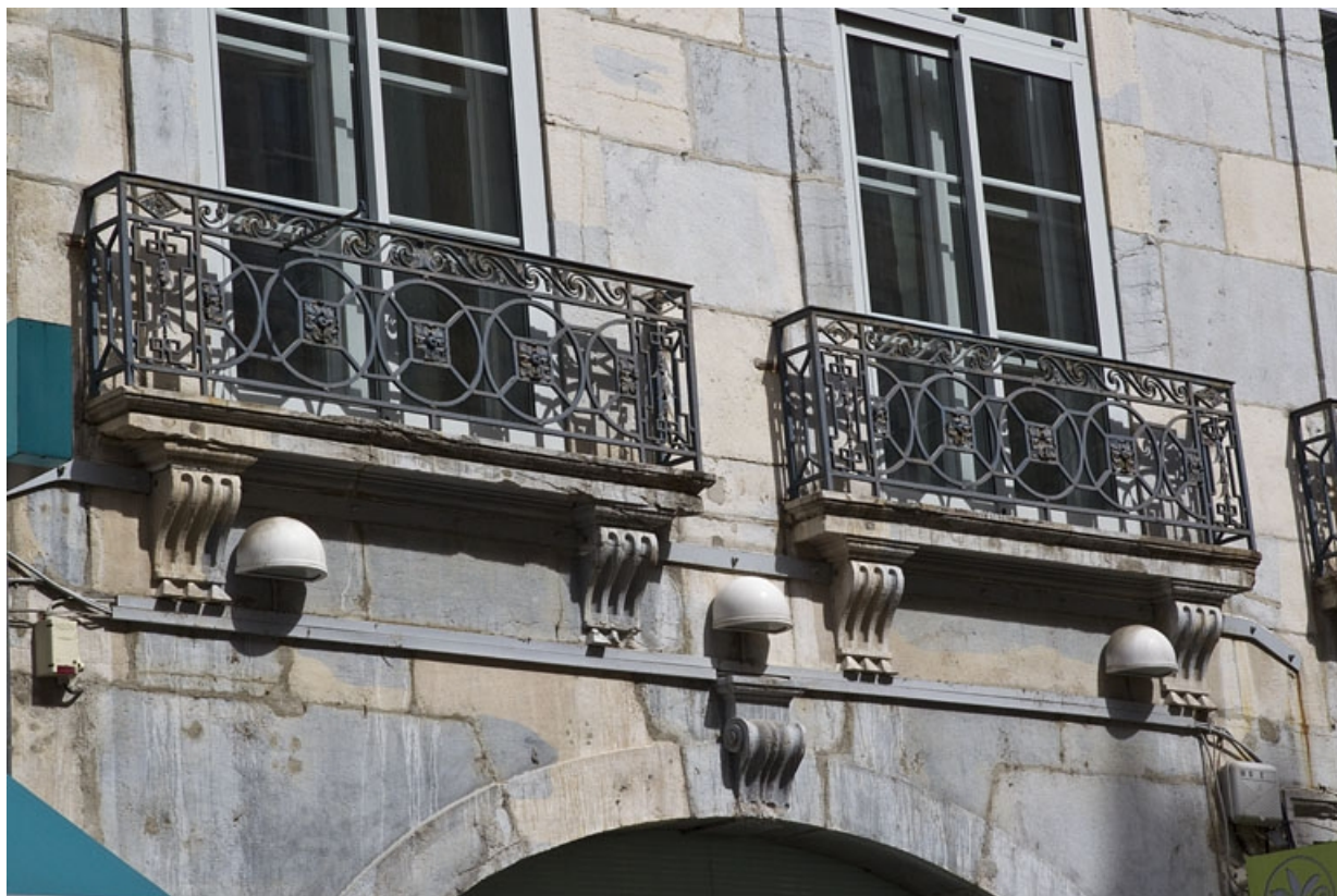
Logis principal, façade antérieure : détail de deux garde-corps en ferronnerie, fenêtres du premier étage. 25, Besançon Grande Rue 39, lieudit : îlot Bouteiller
