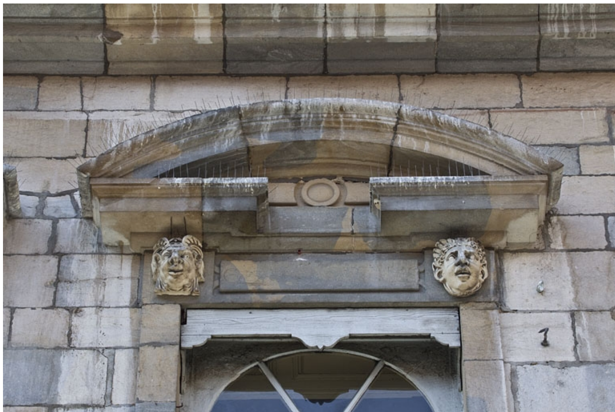
Façade antérieure, partie droite, troisième fenêtre de l'étage à partir de la droite : détail du fronton cintré. 25, Besançon, 2, 4 rue des Granges, lieudit : îlot Bouteiller
