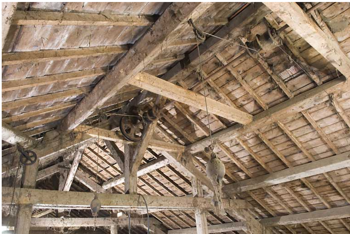
Grange haute : poulies et contrepoids de la déchargeuse dans la charpente. 25, Jougne, 2 chemin de la Tirerie, lieudit : la Ferrière
