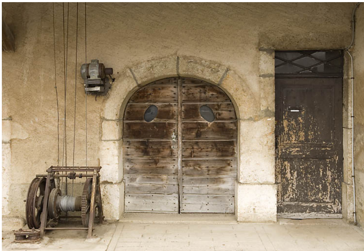
Façade antérieure : portes de l'étable et de l'habitation. 25, Jougne, 1 place des Cloutiers, lieudit : Entre-les-Fourgs
