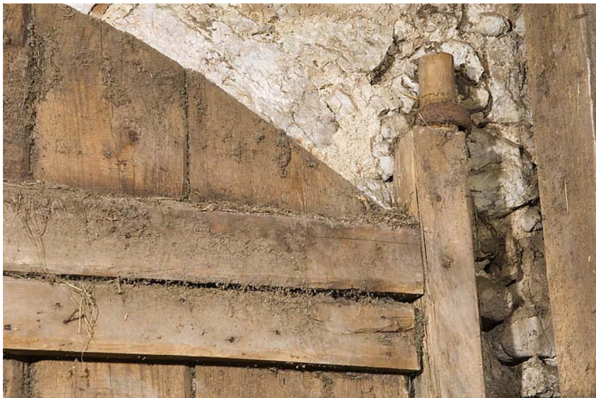
Façade antérieure, porte de grange : fixation de l'axe vertical du vantail de gauche (collier en partie haute). 25, Jougne, 1 place des Cloutiers, lieudit : Entre-les-Fourgs
