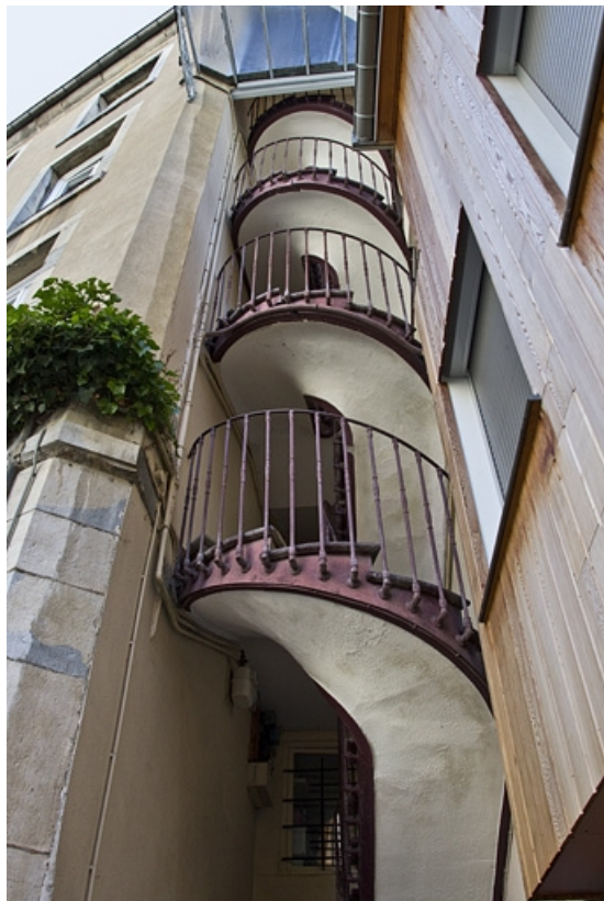
Logis secondaire gauche : détail de l'escalier à cage ouverte à l'extrémité du bâtiment. 25, Besançon, 15 rue Pasteur, lieudit : îlot d' Emskerque
