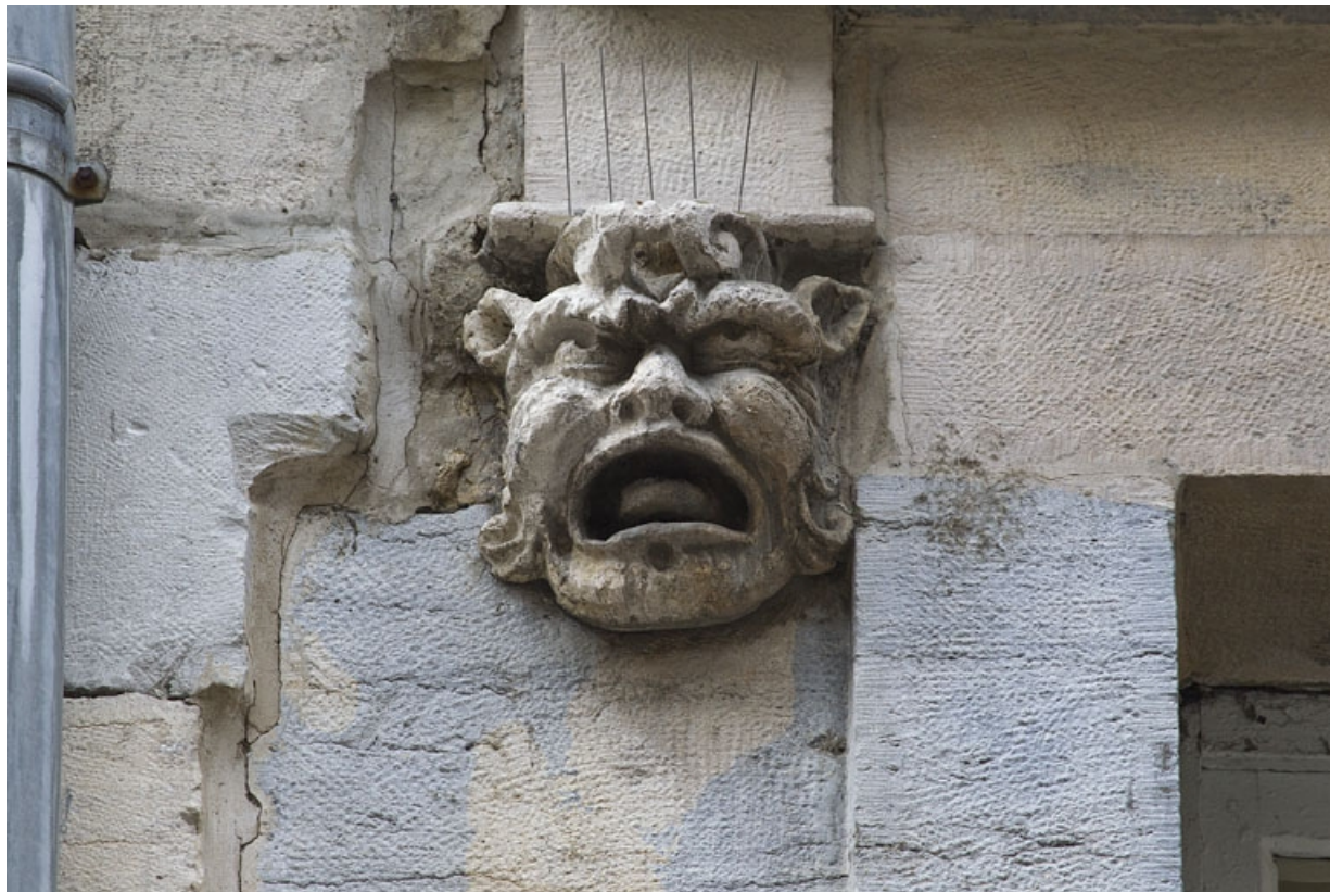
Logis principal, façade sur rue, partie gauche, premier étage, baie gauche : mascaron gauche. 25, Besançon Grande Rue 44, lieudit : îlot d' Emskerque
