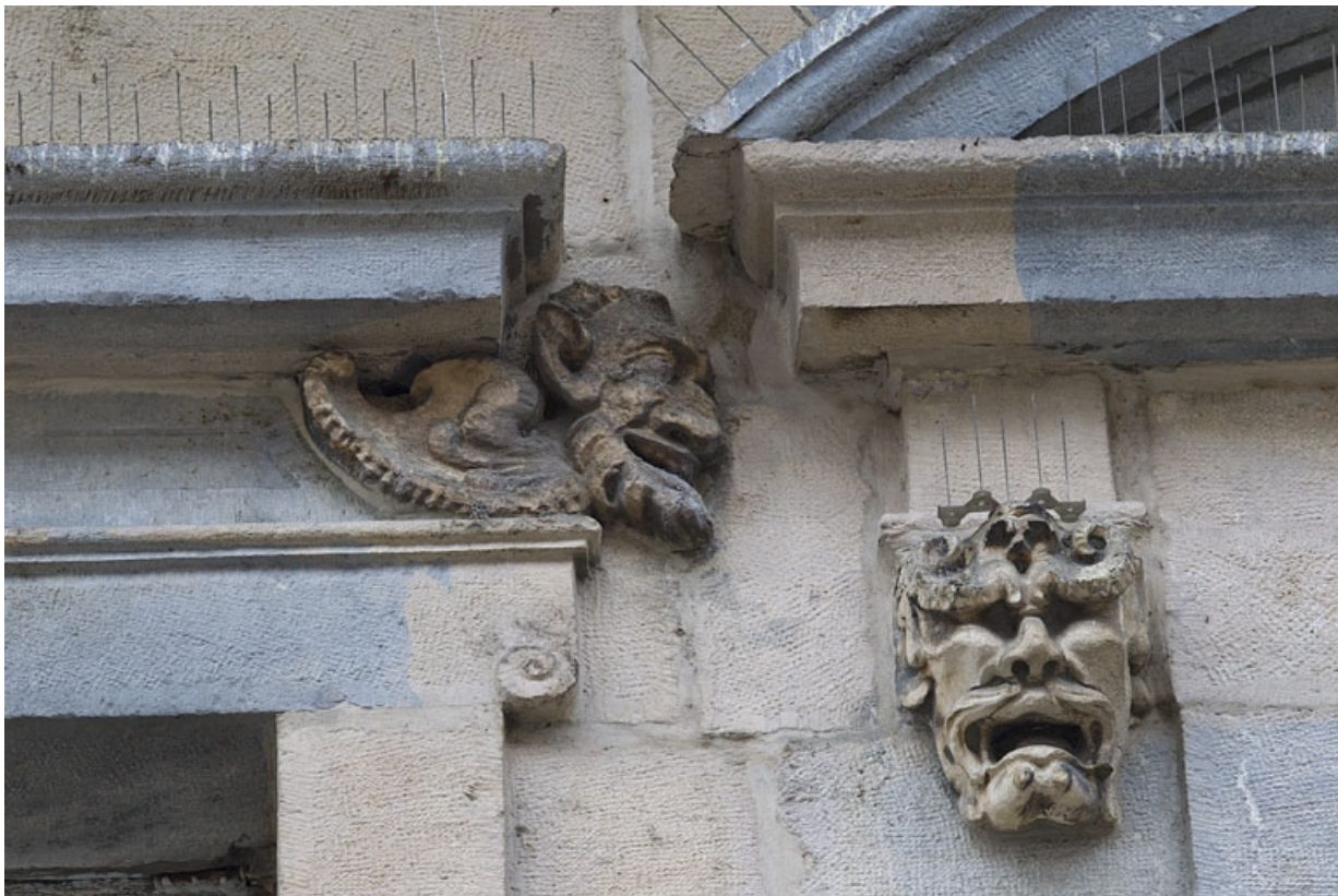
Logis principal, façade sur rue, partie gauche, premier étage, troisième et quatrième baies : mascarons gauche et droit. 25, Besançon Grande Rue 44, lieudit : îlot d' Emskerque
