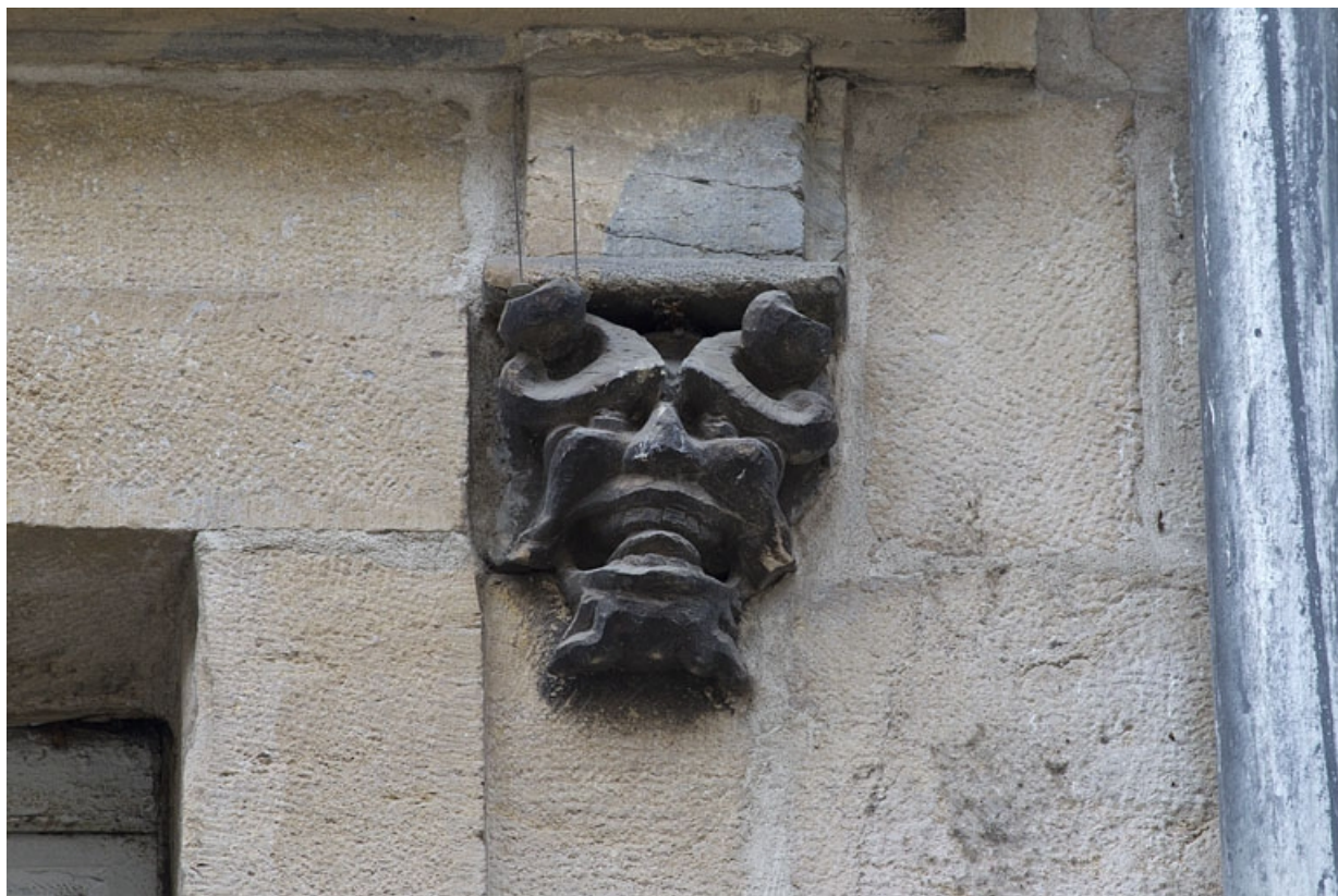
Logis principal, façade sur rue, premier étage, partie droite, cinquième fenêtre : mascaron droit. 25, Besançon Grande Rue 44, lieudit : îlot d' Emskerque
