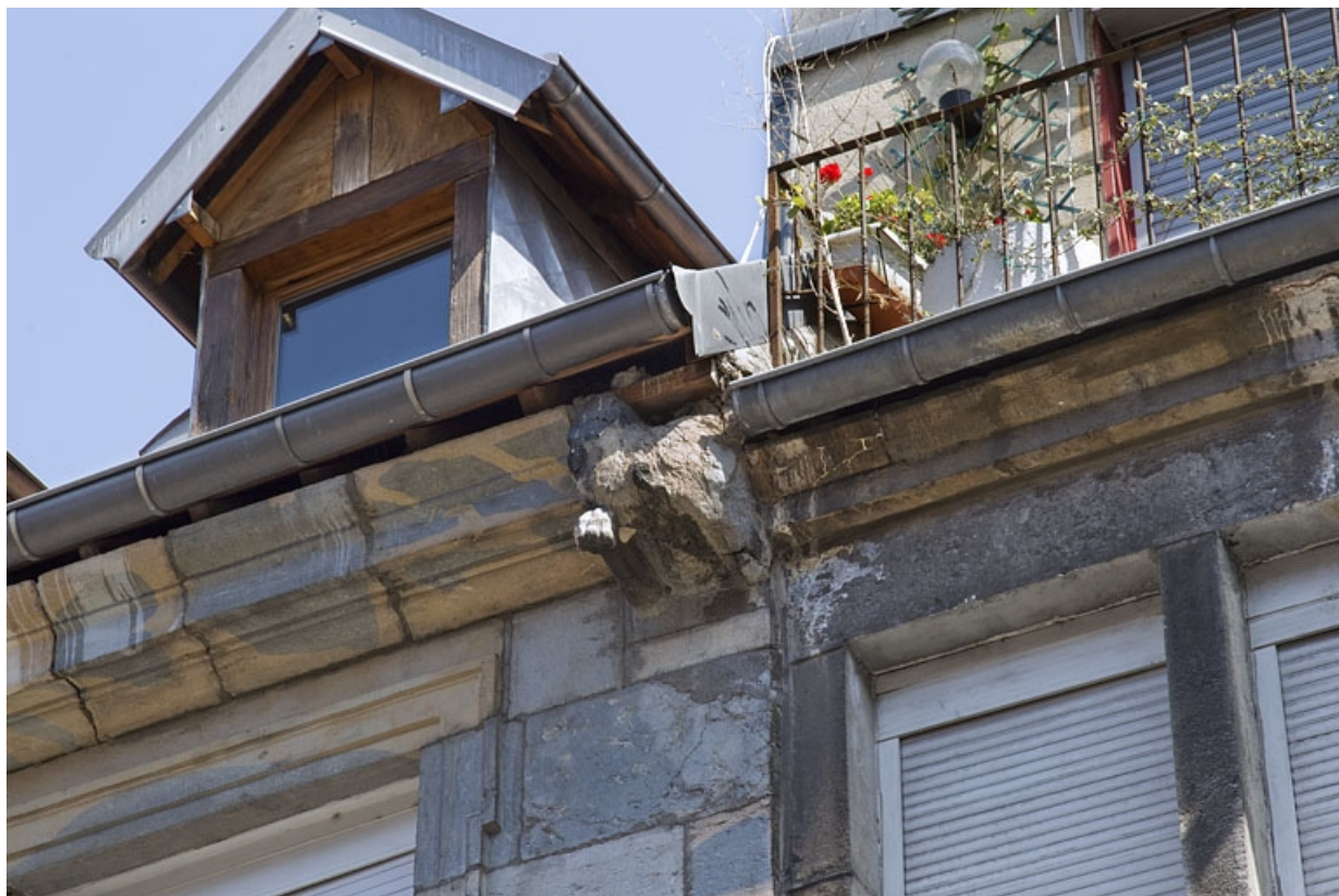
Logis principal, façade antérieure : détail de la gargouille droite.
