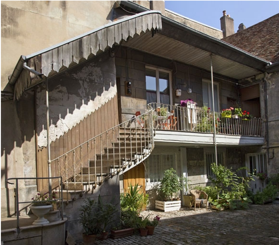
Premier logis secondaire : détail de l'escalier extérieur, de trois quarts gauche. 25, Besançon, 19 rue de Pontarlier, lieudit : îlot des Jacobins
