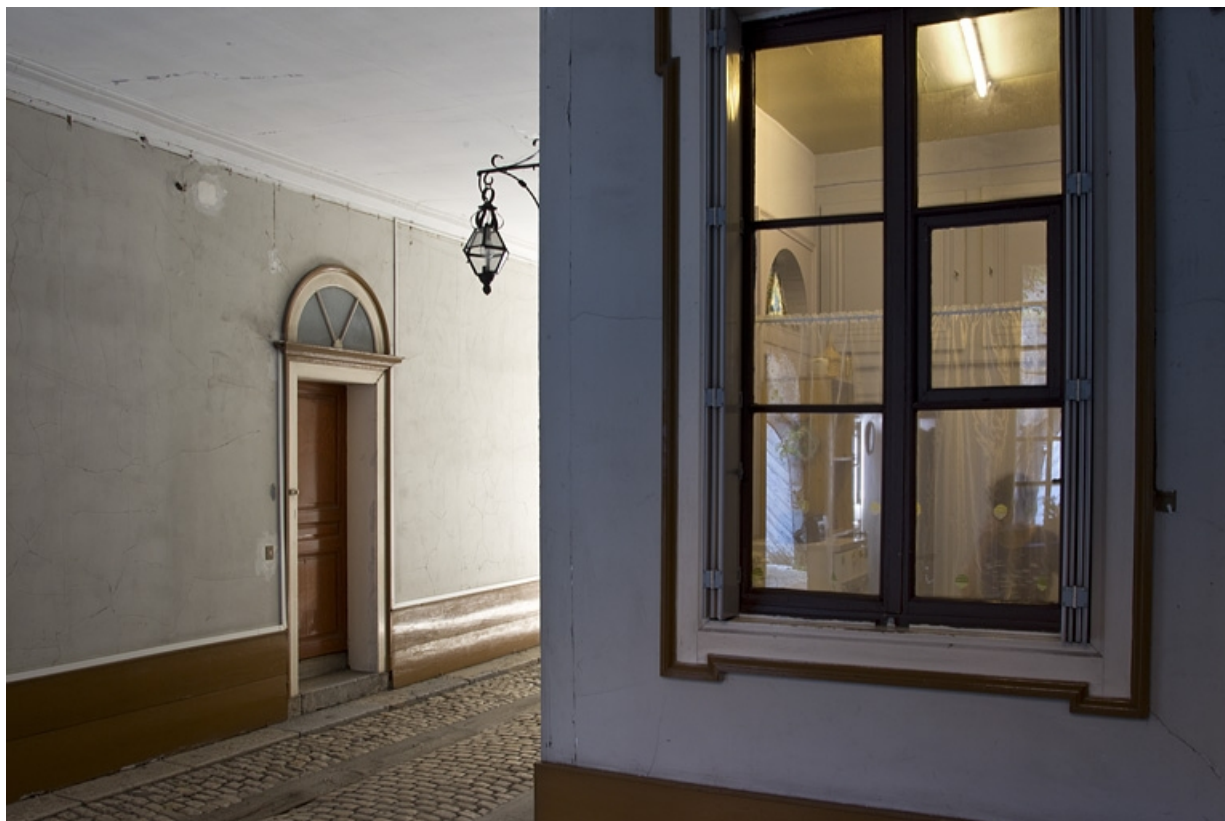
Logis principal, intérieur : détail de l'allée cochère depuis l'entrée de l'escalier. 25, Besançon, 22 rue de la Préfecture, lieudit : îlot Mairie
