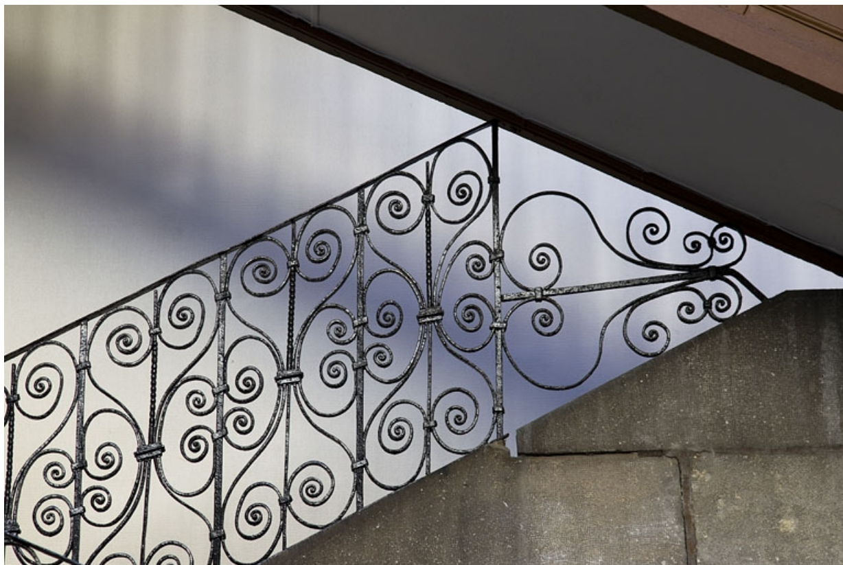
Escalier à cage ouverte à droite de la première cour : détail du décor de la rampe en ferronnerie.
