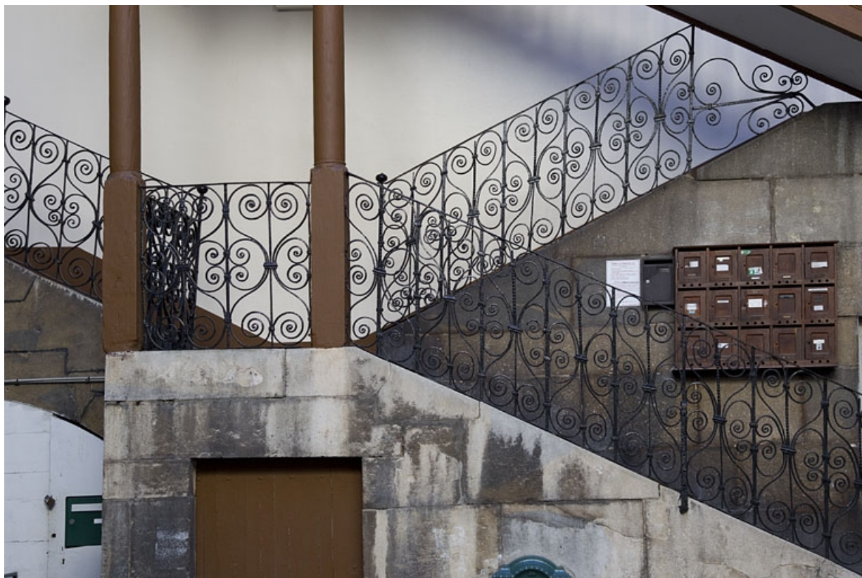
Escalier à cage ouverte à droite de la première cour : détail de la rampe en ferronnerie.
