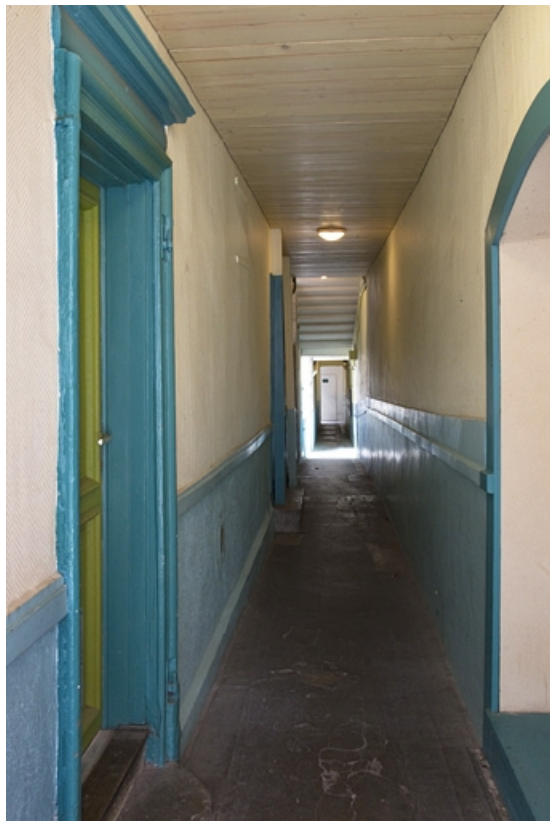
Logis principal : vue d'ensemble du couloir depuis l'entrée. 25, Besançon, 14 rue de la Vieille Monnaie, lieudit : îlot Refuge
