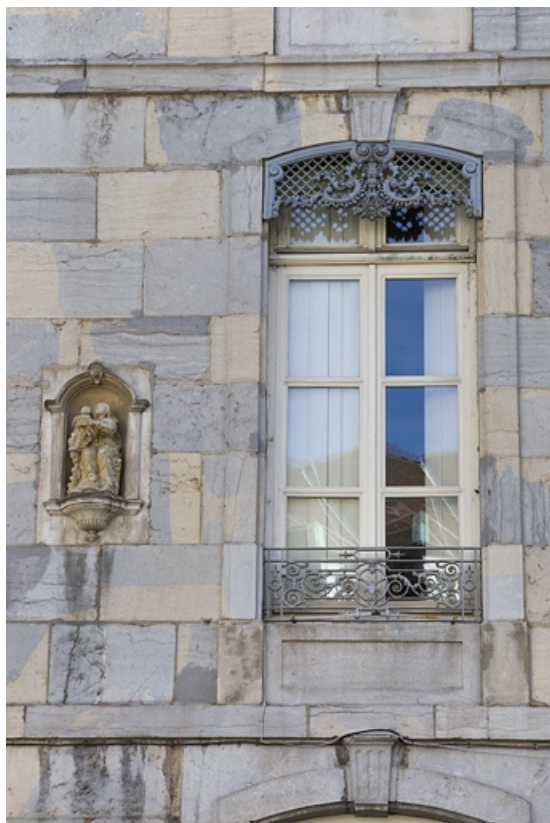
Logis principal, façade antérieure : détail d'une fenêtre et de la niche gauche. 25, Besançon, 1 rue Lecourbe, lieudit : îlot Refuge
