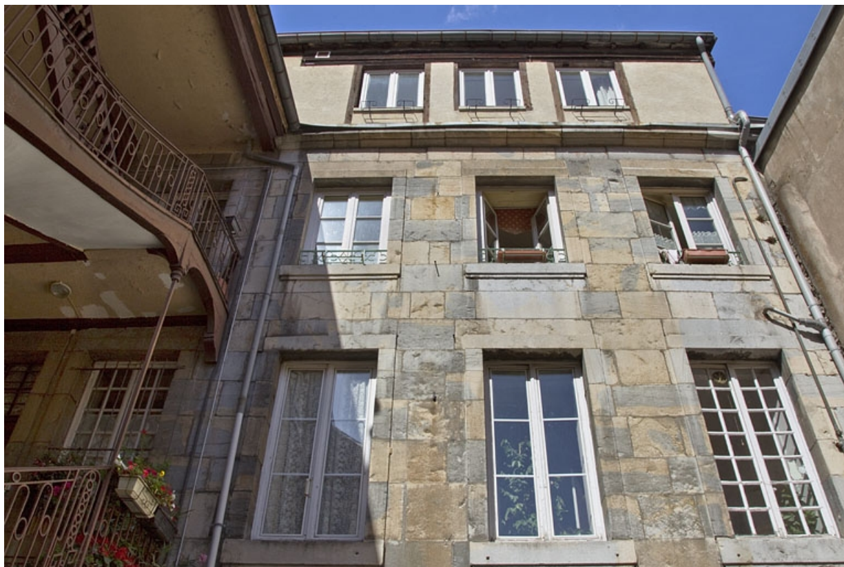
Logis principal, façade postérieure : de face. 25, Besançon, 37 rue Renan, lieudit : îlot Cingle
