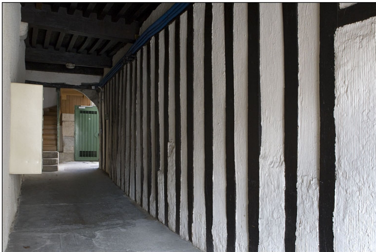
Vue du mur latéral droit, en pan de bois, du passage cocher.
