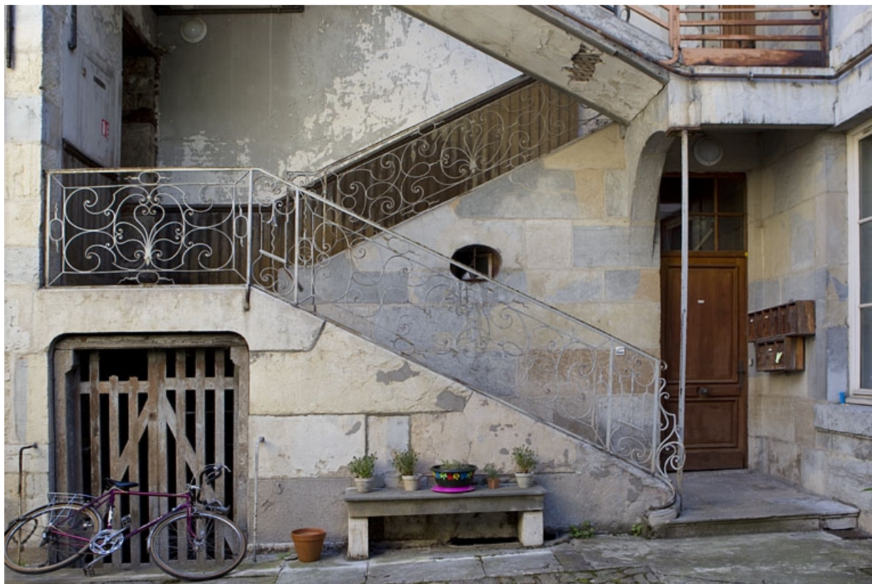
Détail du départ de l'escalier à cage ouverte dans la première cour.
