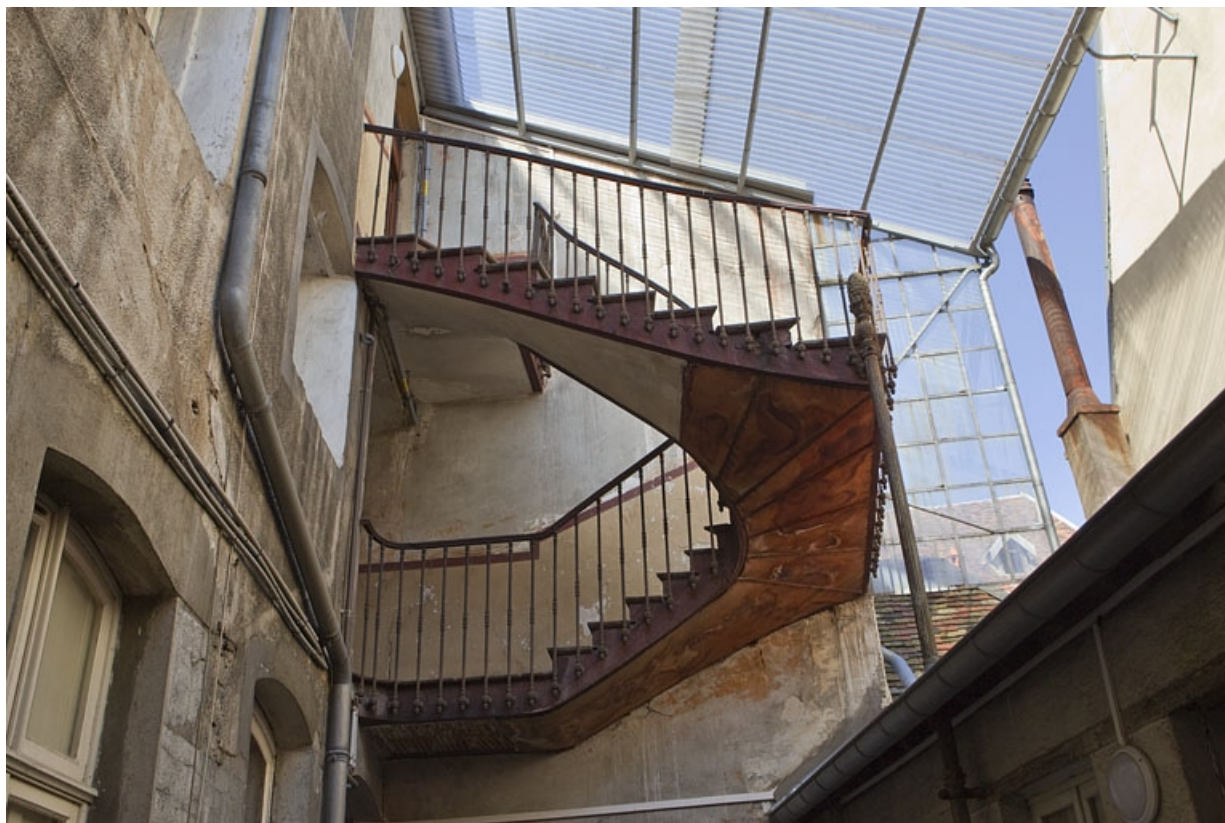
Détail sur cour de l'escalier extérieur en métal entre le premier et le dernier étage : vue rapprochée.
