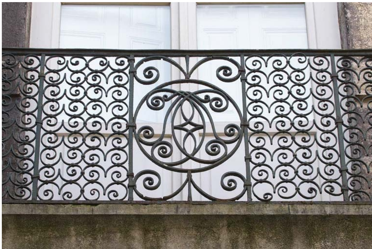
Logis principal, façade sur cour : détail de la ferronnerie d'un garde-corps. 25, Besançon, 133 Grande Rue, lieudit : îlot Saint-Maurice
