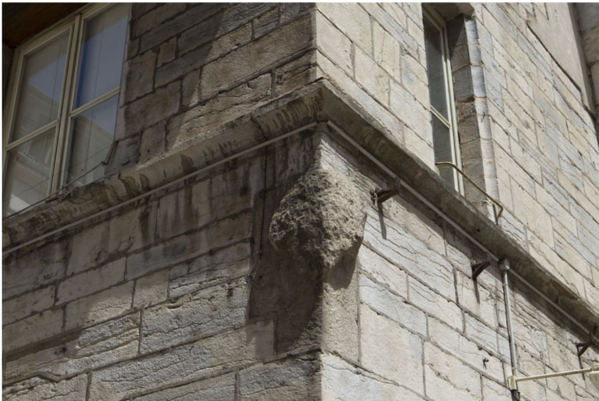
Logis principal, façade sur rue : détail des armoiries bûchées.
