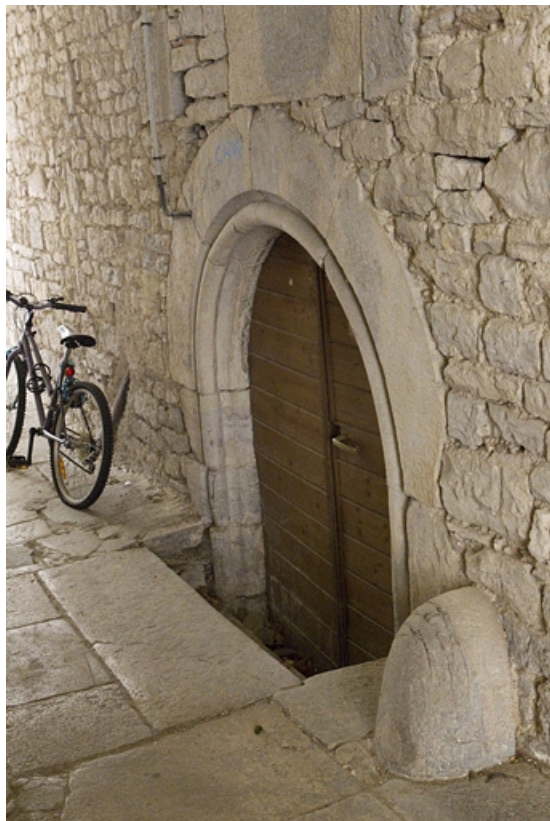
Détail de l'entrée de la cave de la maison entre les deux cours.
