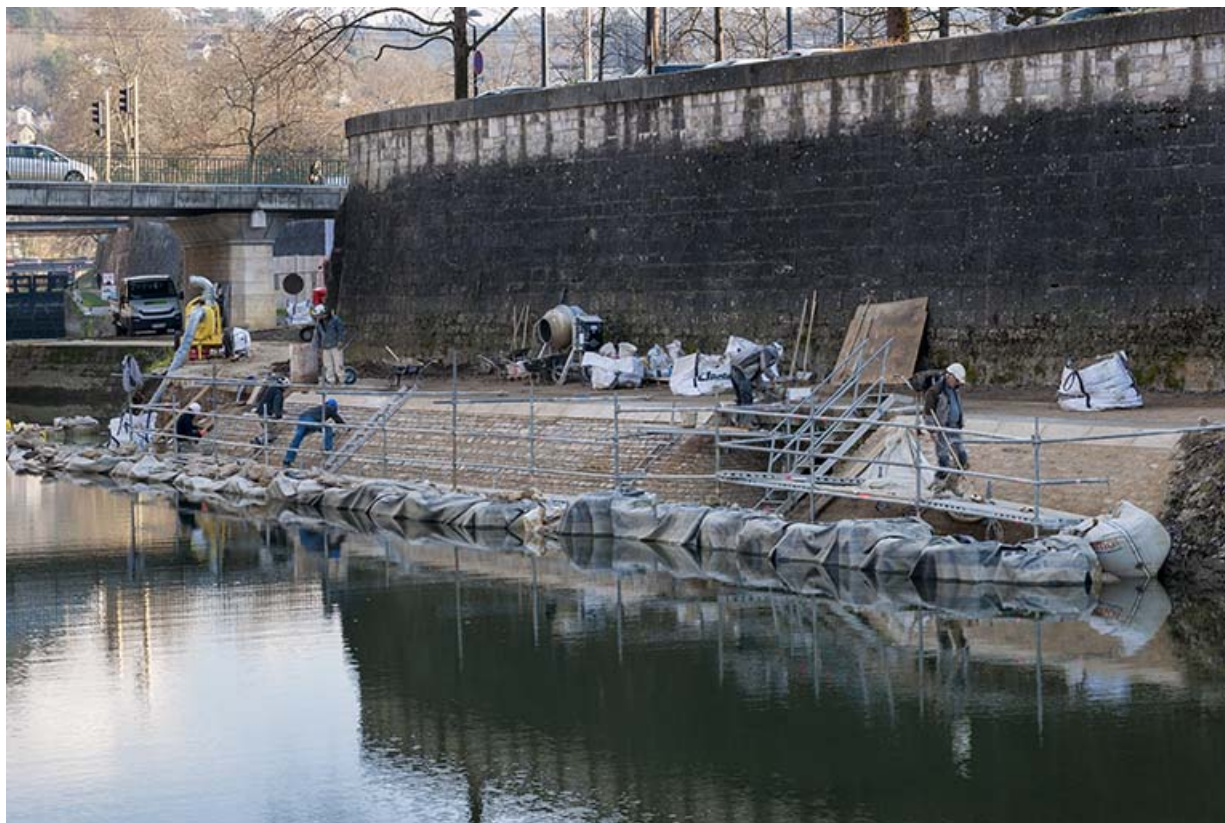
Réfection du perré du chemin de halage en aval du moulin Saint-Paul : vue d'ensemble depuis l'aval. 25, Besançon
