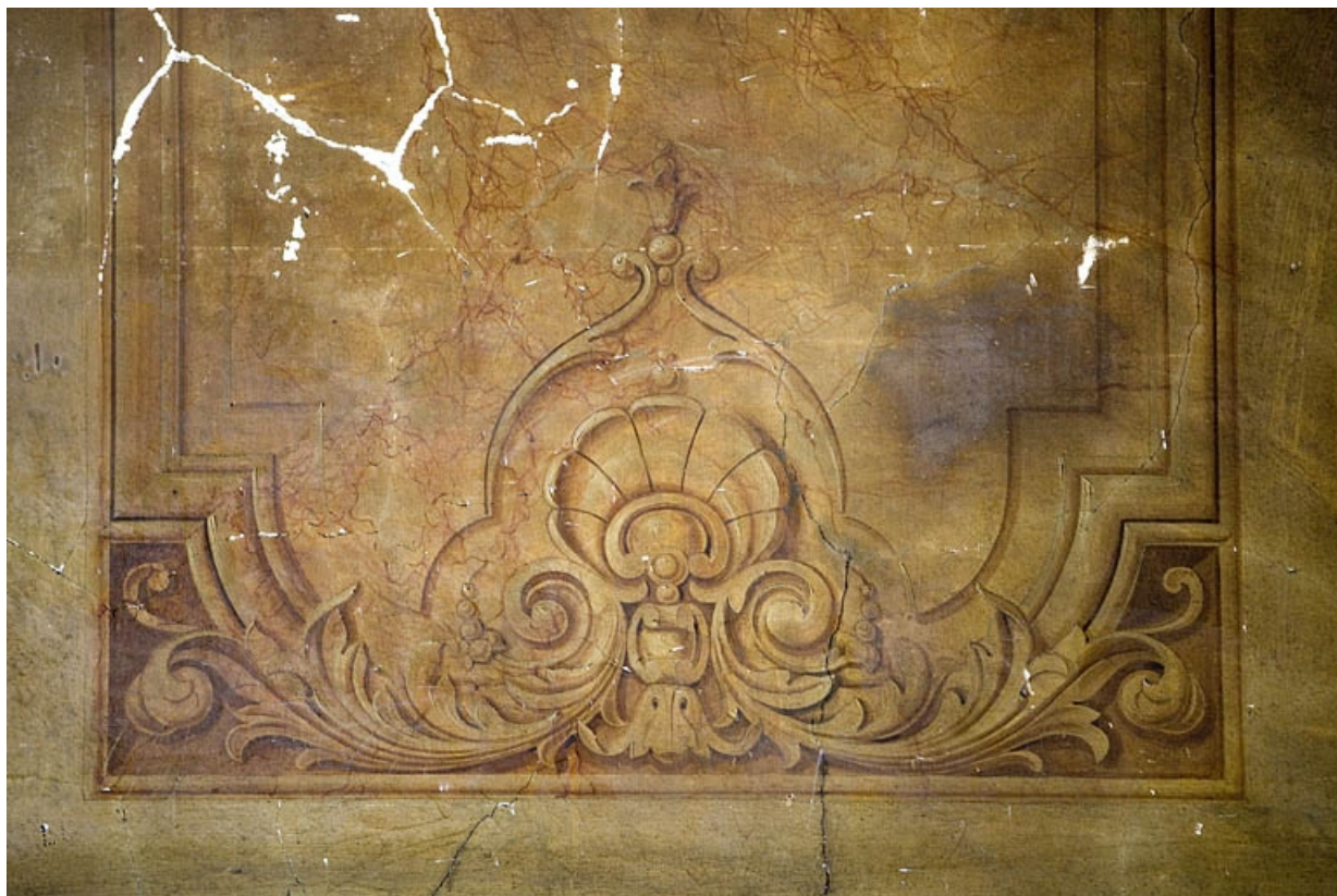
Peintures murales du passage cocher : détail du décor à la partie inférieure d'un panneau.
