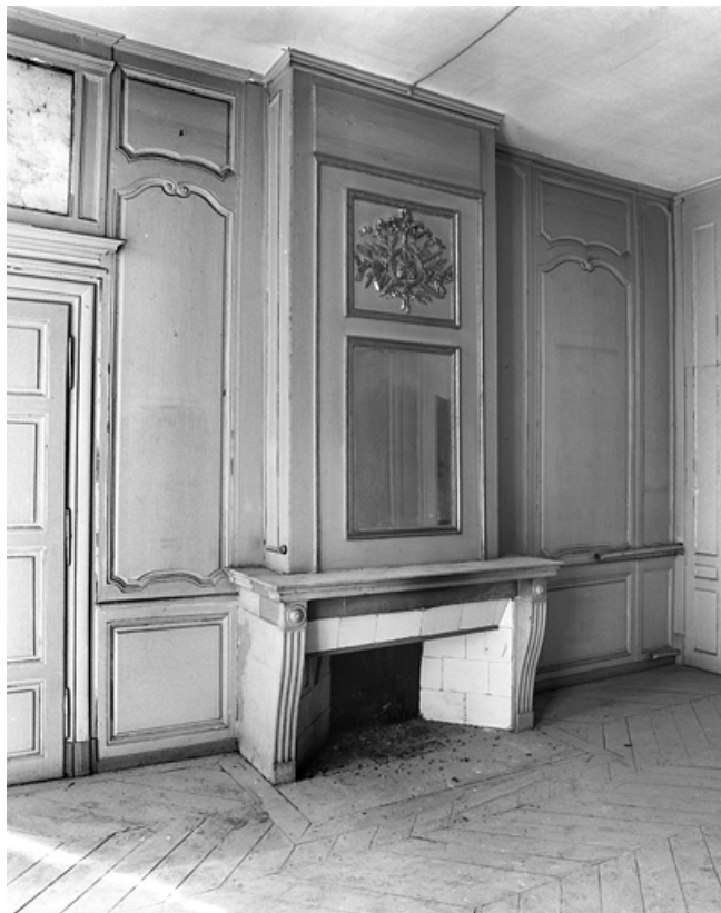
Logis principal : vue d'une cheminée dans une pièce du premier étage. 25, Besançon, 86 rue des Granges, lieudit : îlot Forum
