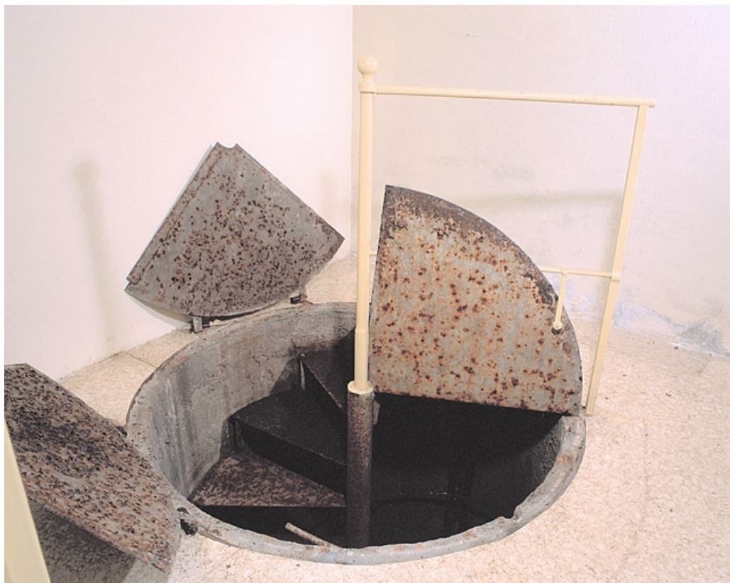
Sous-sol, salle ouest : puits des pendules à pression constante, trappe ouverte.
