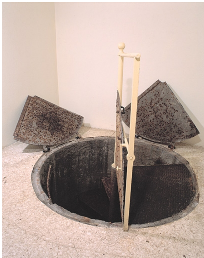
Sous-sol, salle ouest : puits des pendules à pression constante, trappe partiellement ouverte. 25, Besançon, 34 avenue de l' Observatoire, lieudit : la Bouloie
