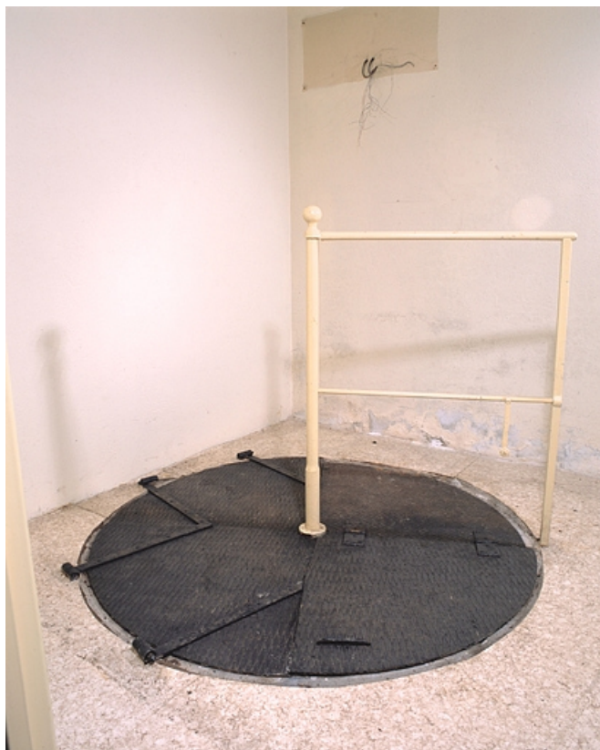
Sous-sol, salle ouest : puits des pendules à pression constante, trappe fermée. 25, Besançon, 34 avenue de l' Observatoire, lieudit : la Bouloie
