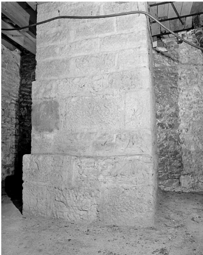
Sous-sol de la tour de l'équatorial coudé : vue d'ensemble rapprochée du pilier de la lunette. 25, Besançon, 34 avenue de l' Observatoire, lieudit : la Bouloie
