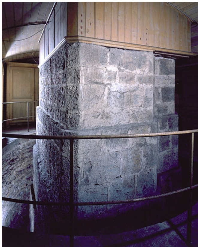
Sous-sol : pilier de la lunette méridienne (cadrage vertical). 25, Besançon, 34 avenue de l' Observatoire, lieudit : la Bouloie
