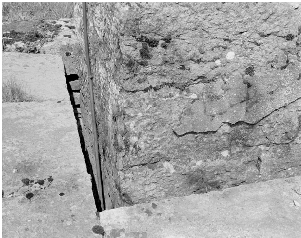
Pilier sud des mires sud de la lunette méridienne : espace entre le pilier et son puits.
