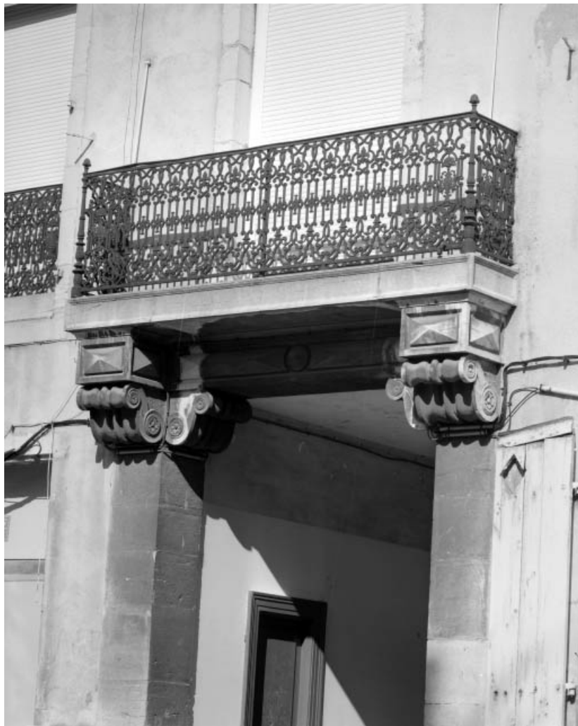
Façade postérieure du corps de logis sur cour, détail du balcon au-dessus de l'entrée cochère. 25, Besançon Grande Rue 14, lieudit : îlot Pasteur
