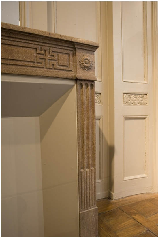
Détail de la partie droite de la cheminée située au premier étage.
