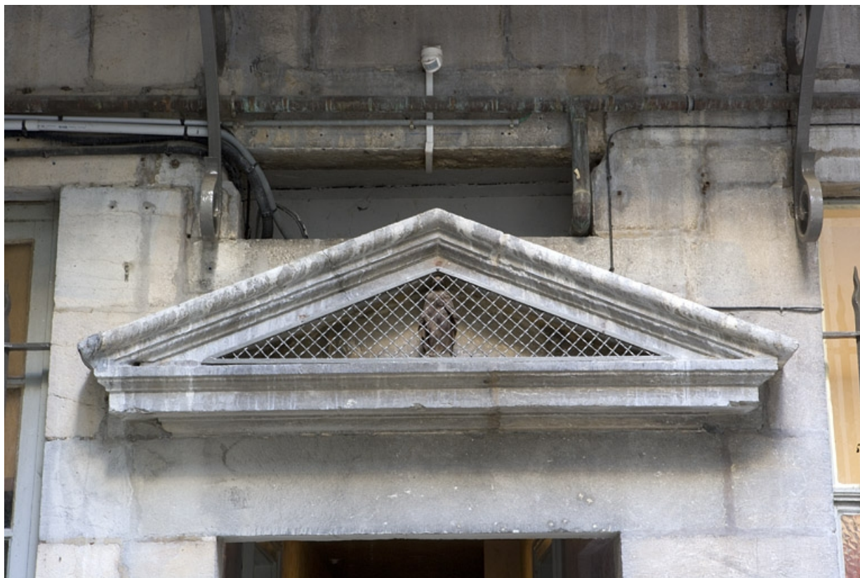
Façade postérieure du logis principal : détail du fronton sur la porte du couloir d'entrée. 25, Besançon, 11 Grande Rue, lieudit : îlot Chevanney
