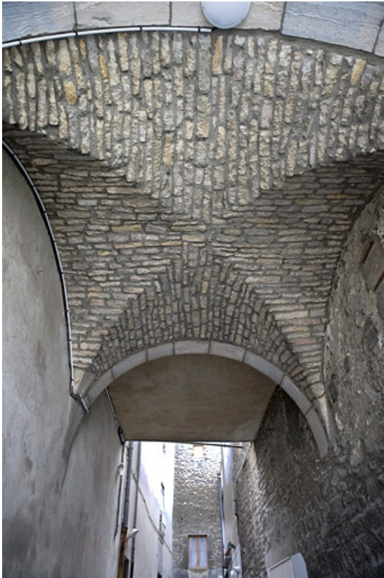
Détail de la voûte du passage au-dessus de l'ancien trage. 25, Besançon, 12 place de la Révolution, lieudit : îlot Chevanney
