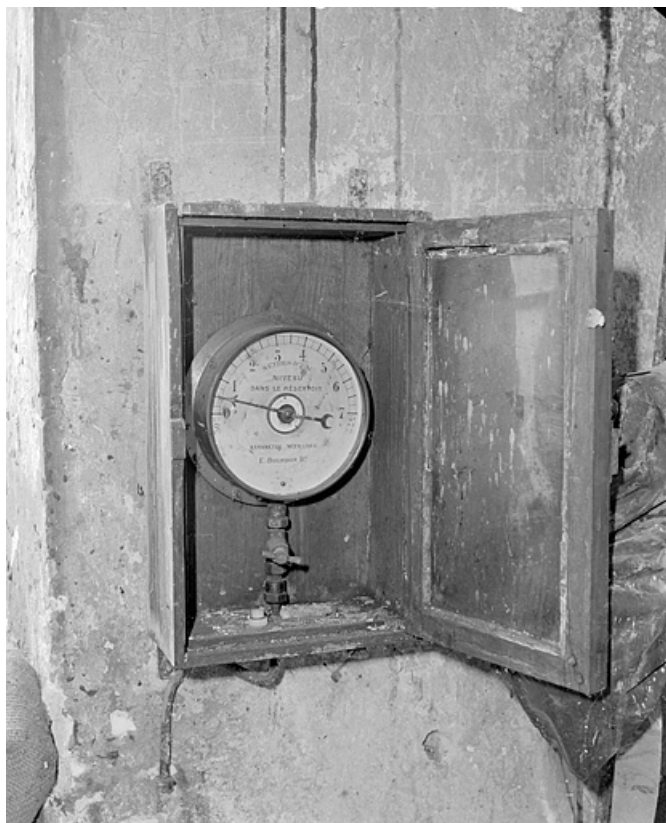
Placé dans l'atelier de mécanique, au-dessus de la pompe, ce cadran permettait de contrôler le niveau d'eau du réservoir. 25, Baume-les-Dames rue des Pipes, lieudit : Gondé
