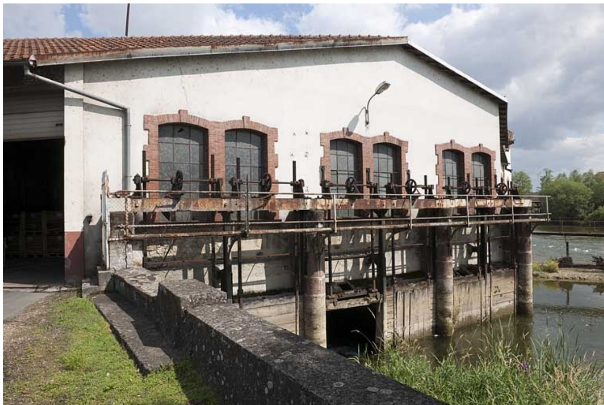
Vannage de prise d'eau devant le pignon d'un magasin industriel.
