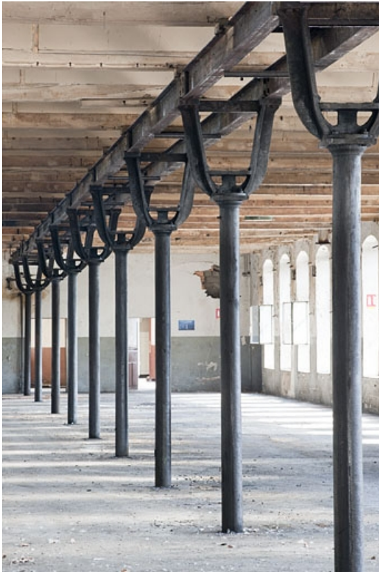
Atelier de fabrication nord. File de colonnes depuis le sud-ouest.
