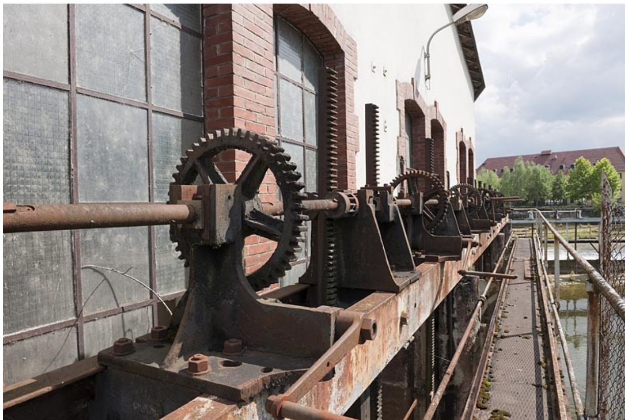
Détail du vannage de prise d'eau.
